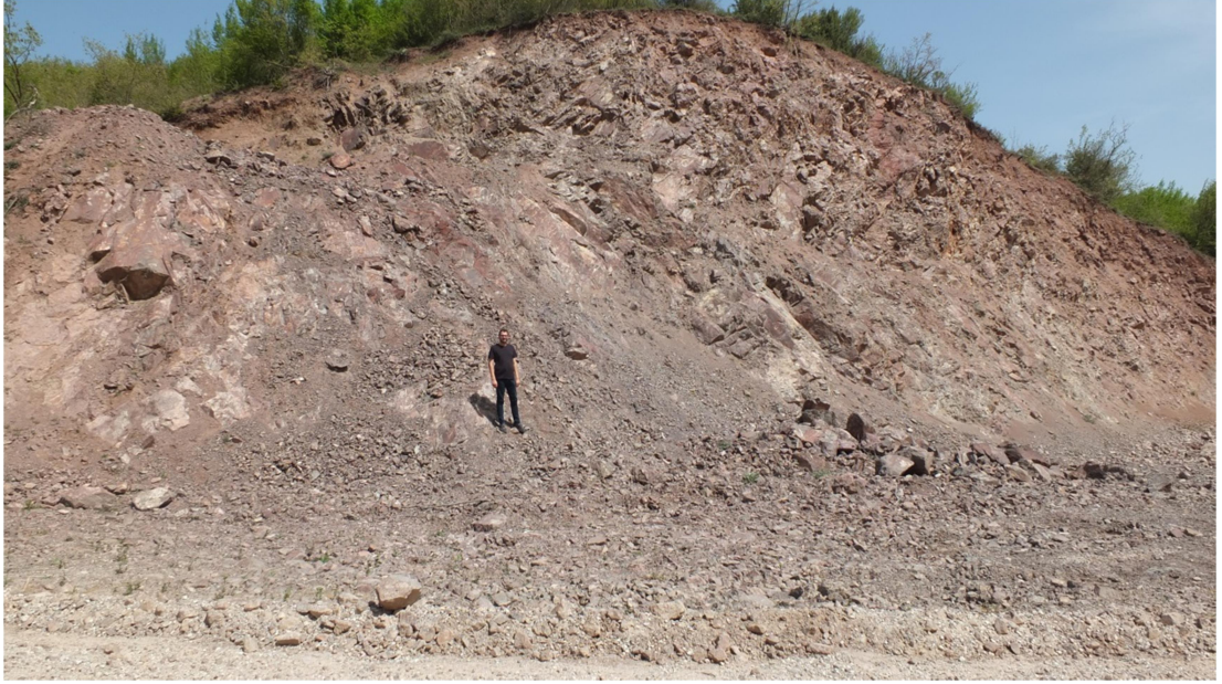
Şekil 2: Ertuğrul - Sarıalan kırsal mahalleleri arasındaki karayolu kenarında otoyol inşaatında kullanılmak üzere dolgu malzemesi alınan andezit ana kayanın görünümü
