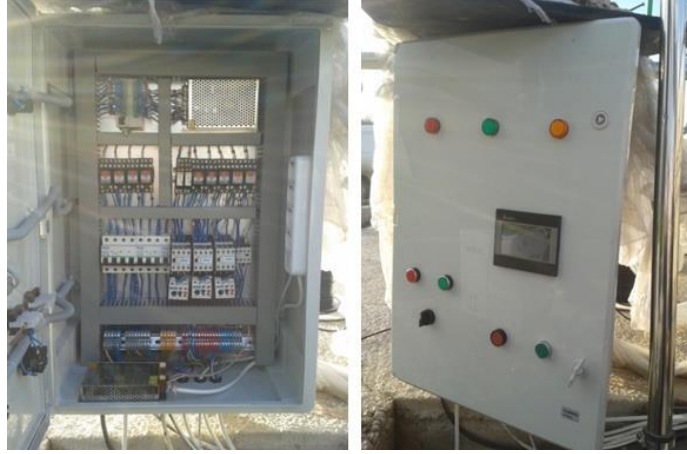
Şekil 5.38: PLC kontrollü sağım odası panosu.
