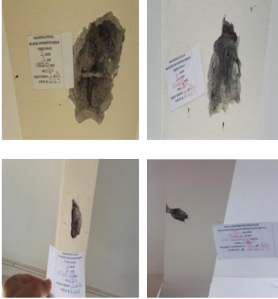
Şekil 4.11: İncelenen yapıda kirişlerde pas payı sıyırma ile donatı tespiti.
