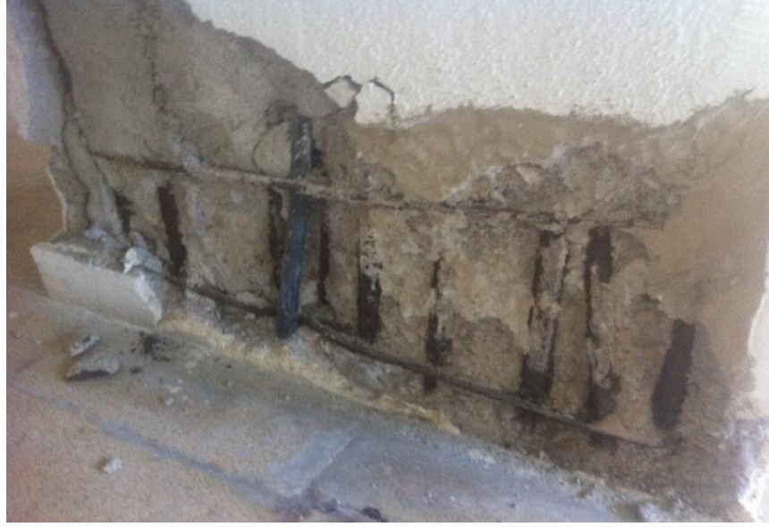
Şekil 4.12: Korozyondan dolayı hasar görmüş kolon.
