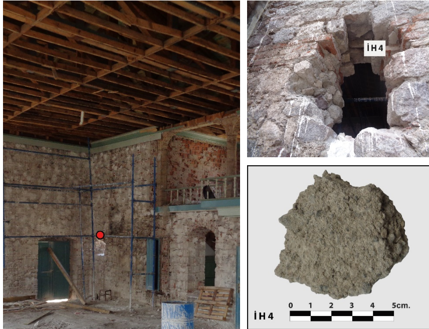
Şekil 5.24: İH4 numunesi ve yapıdaki yeri.
