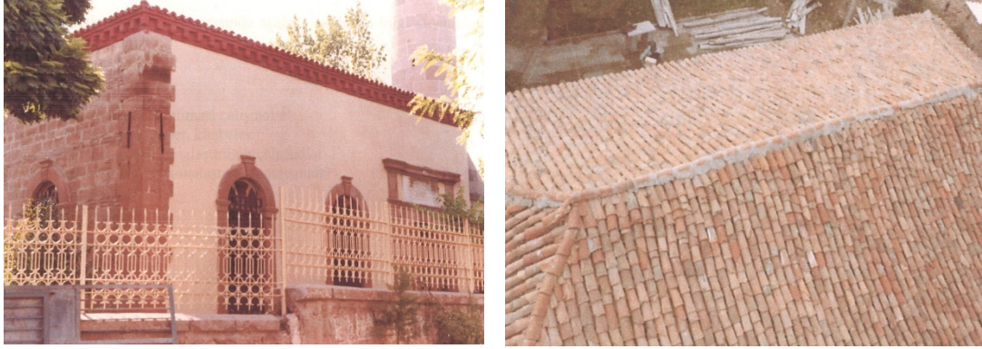
Şekil 4.15: Kaya Bey Camisinin 1986 tarihli onarım sonrası doğu cephesi ve çatısı (BVBM arşivi).
