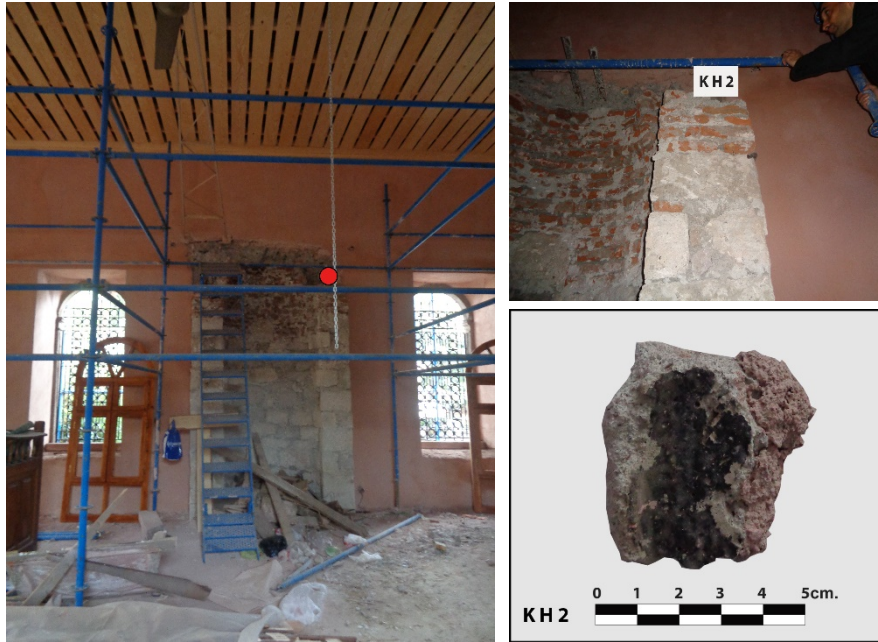
Şekil 5.10: KH2 numunesi ve yapıdaki yeri.
