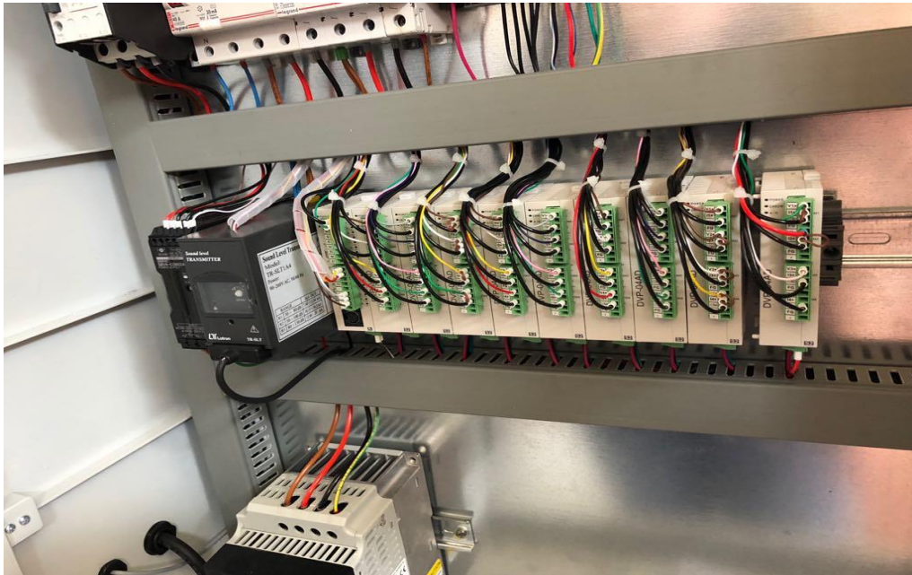
Şekil 4.13: PLC ve modülleri.
