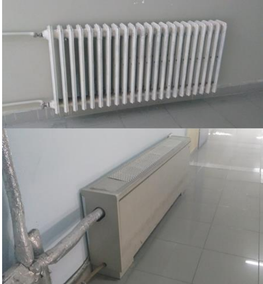
Resim 3.5: M.M.F binasında bulunan mevcut radyator ve fan coil.
