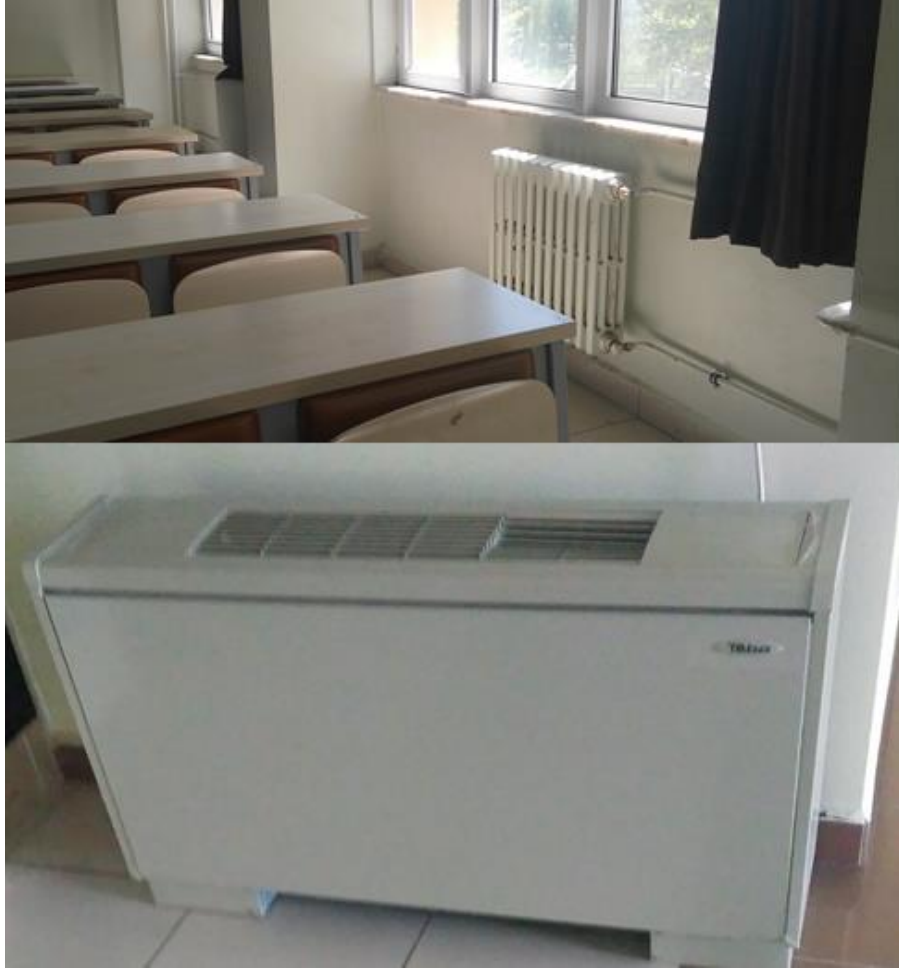
Resim 3.9: F.E.F binasında bulunan radyatör ve fancoil.
