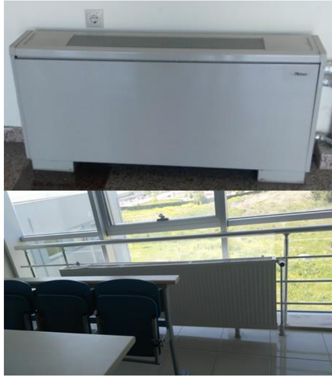
Resim 3.17: B.E.S.Y.O binasında bulunan radyatr ve fan coil.
