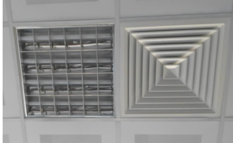
Resim 3.16: B.E.S.Y.O binasında bulunan aydınlatma elemanları.
