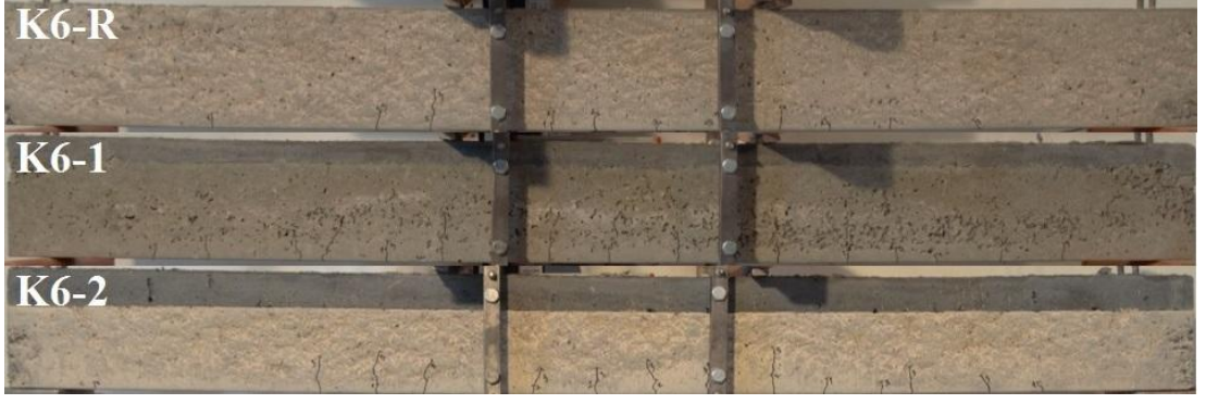
Şekil 2.37: K6 ( \rho=0.0507 ) kirişlerine ait çatlak dağılımları ( L/250 yerdeğiřtirmesi).
