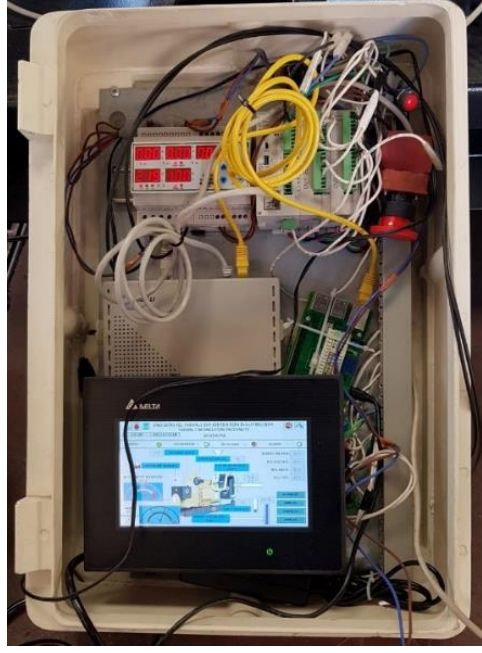
Şekil 3.51: Elektrik panosu ve malzeme yerleşimi.
