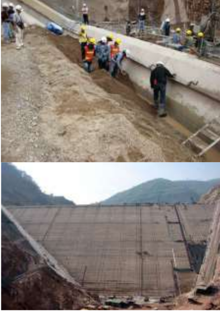
Şekil 20-Nam Ngum 2 Barajında Sıcaklık Algılama Kablo Tesisatı ve Memba Tarafı[12].
