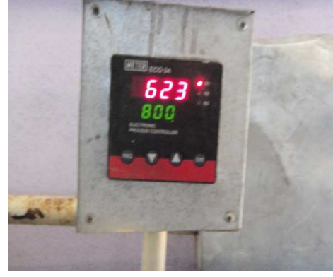
Resim 2.23: Fırının Sıcaklık Kontrol Ünitesi
