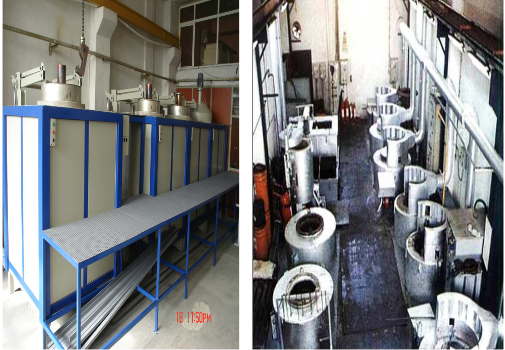
Resim 2.53: Atmosfer Kontrollü Isıl İşlem Fırını ve Tuz Banyosu
