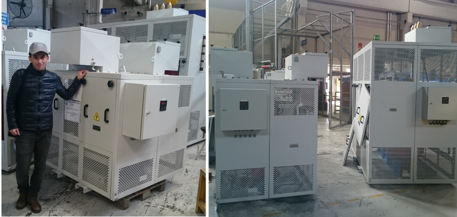
Şekil 3.3: Örnek kabinli kuru tip transformatörler.
