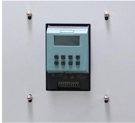
Şekil 2.13: Kontrol panelinde hız kontrol cihazının görünümü.
