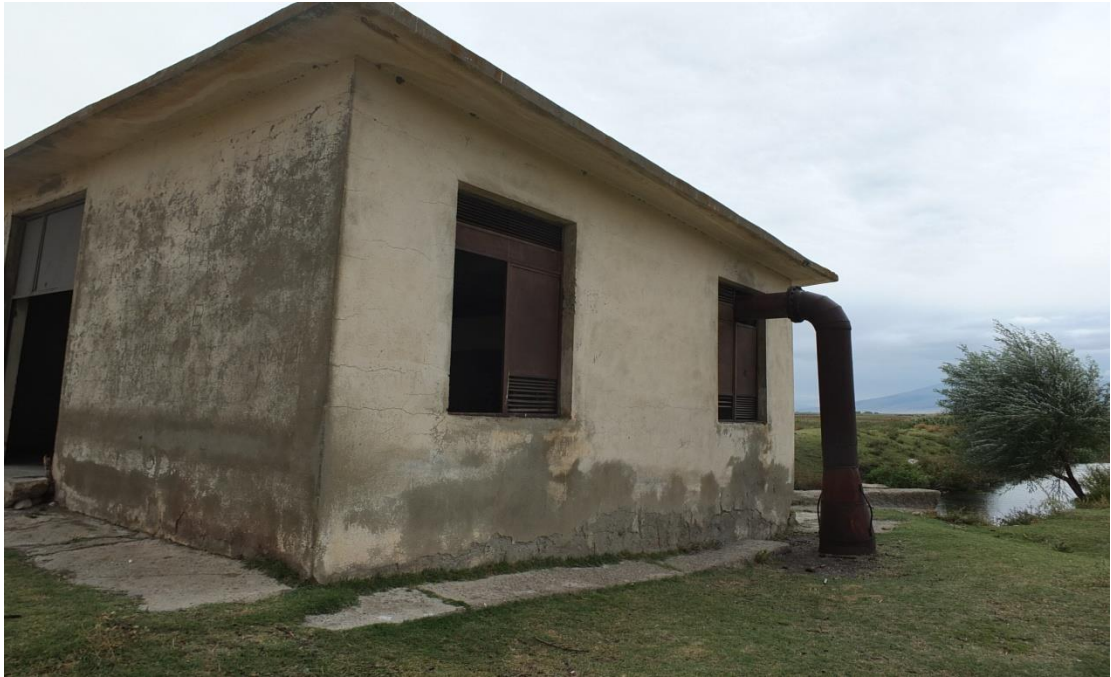
Şekil 36. 2003 Yılına Kadar SEKA'ya Su Pompalayan İstasyon.
