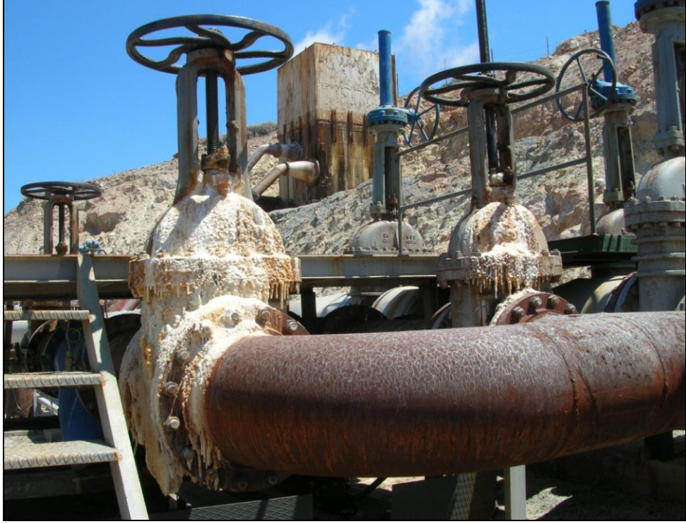
Şekil 4.9 Borulardaki silikat ve kireçlenme probleminin bir görüntüsü
