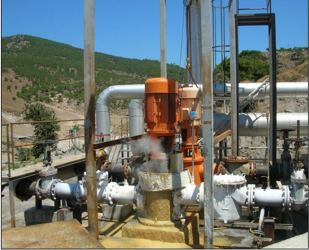
Şekil 4.5 Kuyu başındaki pompa ünitesi (Tuzla)
