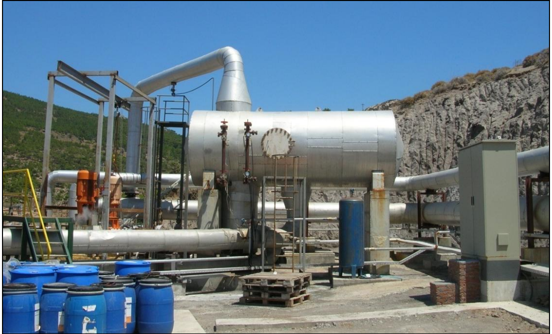
Şekil 4.4 Separatör ünitesi (Tuzla)
