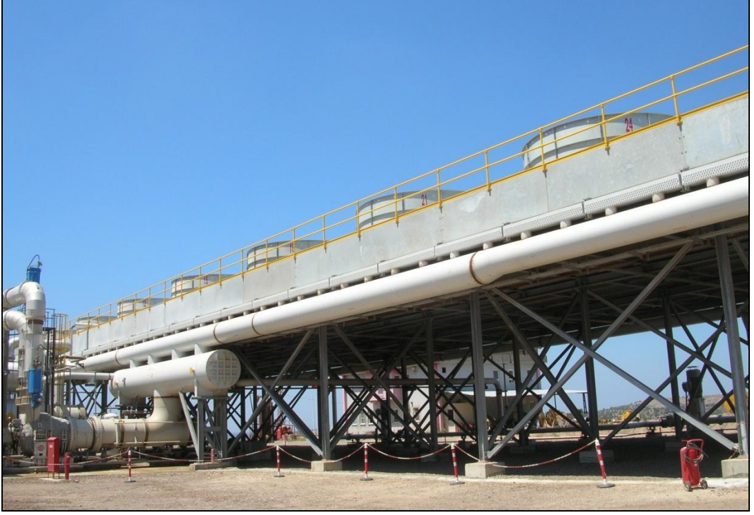
Şekil 4.7 Yoğuşturucu (kondenser) ünitesi (Tuzla)
