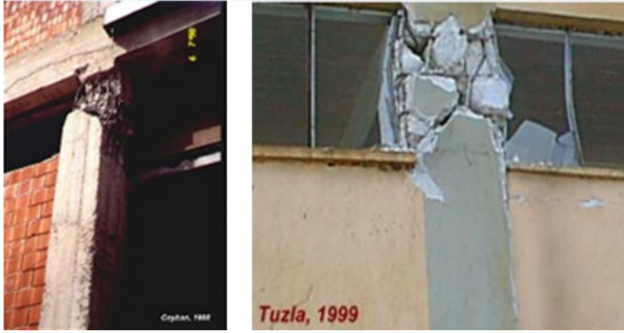
Şekil 5.4: Kısa kolon hasarları.
