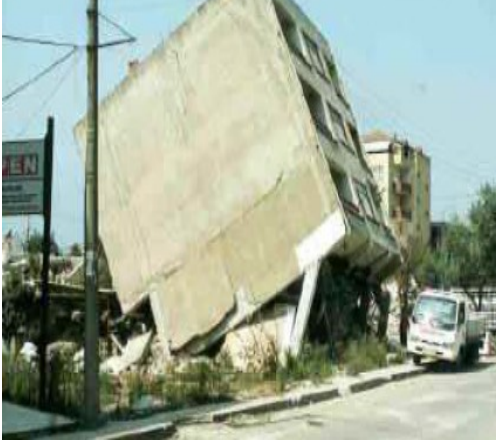
Şekil 5.5: Zayıf kat hasarı.
