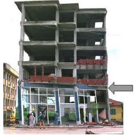
Şekil 5.6: Yumuşak kat hasarı.
