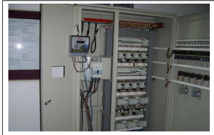
Şekil 2.14: Elektrik ölçümü için sayaç montajı
