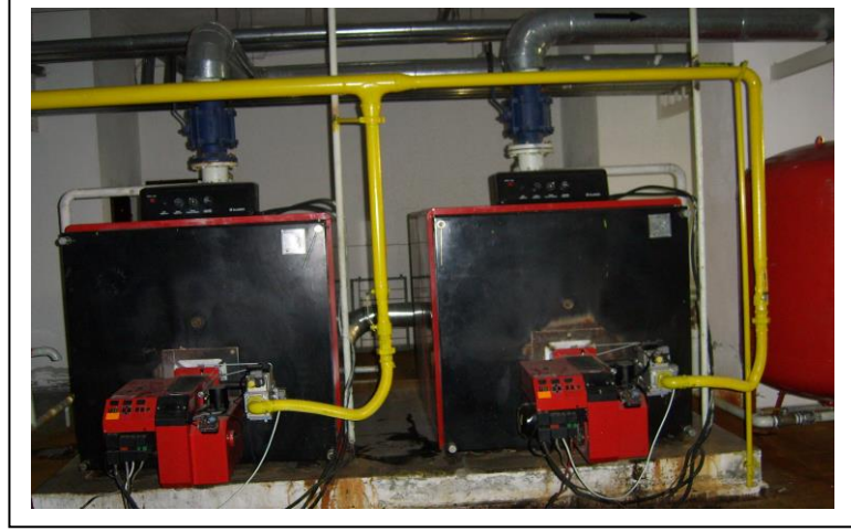
Şekil 2.9: Örnek binanın ısıtma sistemi (kazan) görünümü
