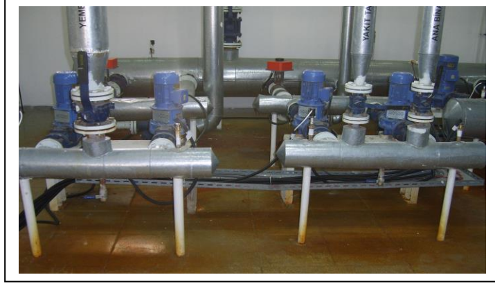
Şekil 2.34: Isıtma sistemi sirkülasyon (santrifüj) pompalarının görünümü
