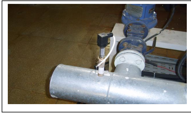
Şekil 2.13: Su basınç ölçümü için transmitter montajı
