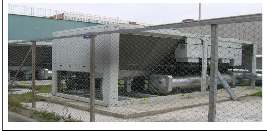
Şekil 2.10: Örnek bina soğutma sistemi (chiller grubu)
