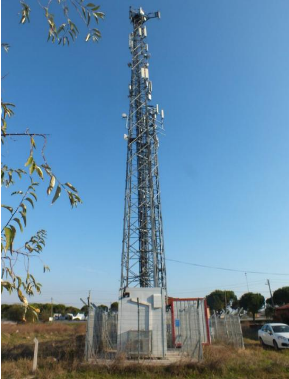
Şekil 4.6: Balıkesir küçük sanayi baz istasyonu
