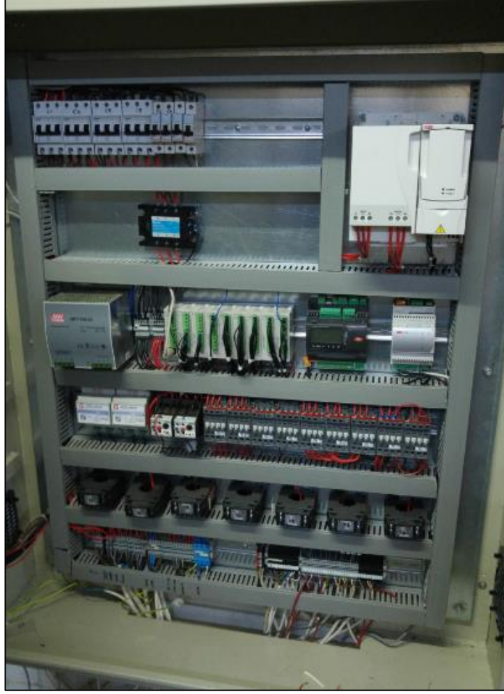
Şekil 5.15: Elektrik kontrol panosu genel görünüş
