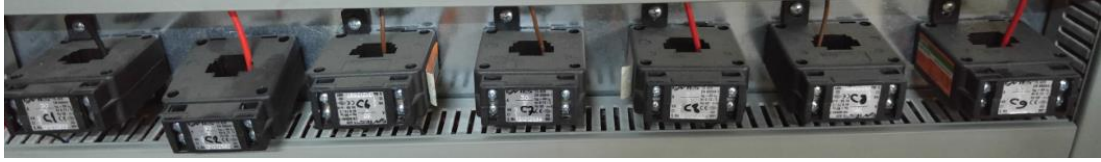
Şekil A.9: Akım trafoları
