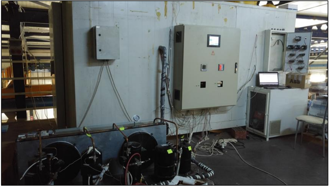
Şekil 5.2: Dış ünite, soğuk depo ve kontrol panosu
