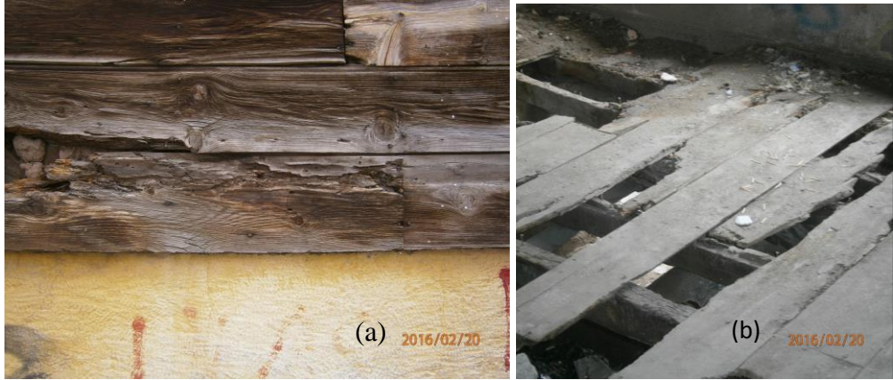
Şekil 6.16: Ahşap malzemede aşınma [10]
