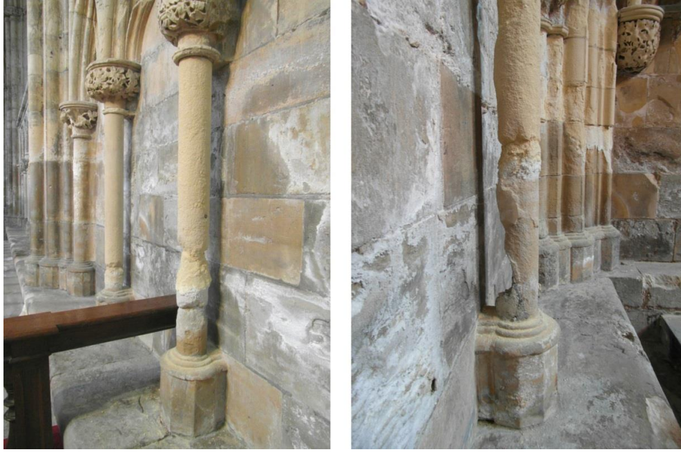
Şekil 3.12: Tuzlanmanın taşa verdiği zararlar [50]
