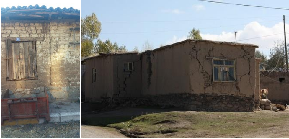
Şekil 3.40: Kerpiç yapıda yapısal çatlak [10]
