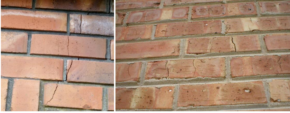
Şekil 3.16: Tuğla yüzeyindeki kılcal çatlaklar [53]
