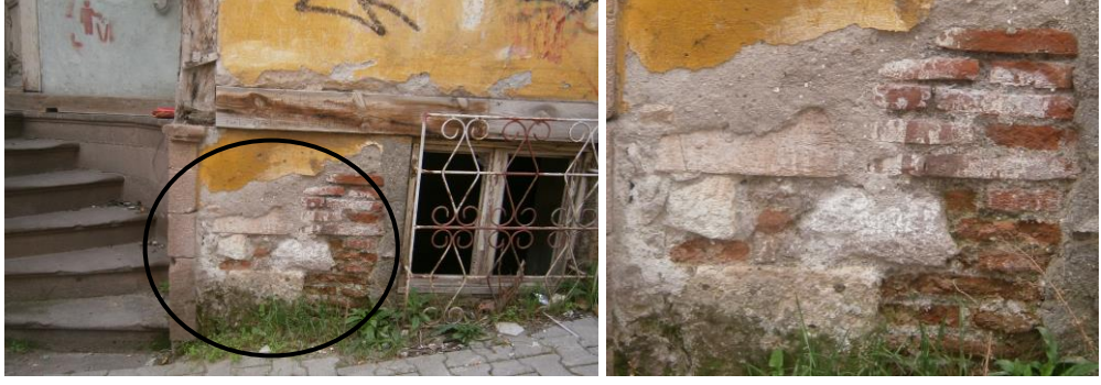
Şekil 6.13: Tuğlada çiçeklenme (tuzlanma) [10]
