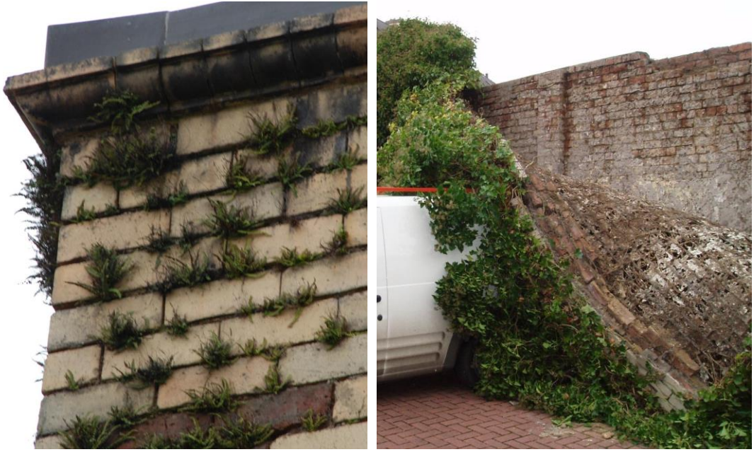
Şekil 3.23: Derzlerinde gelişen bitkilerin duvardaki yıkıcı etkisi [57]
