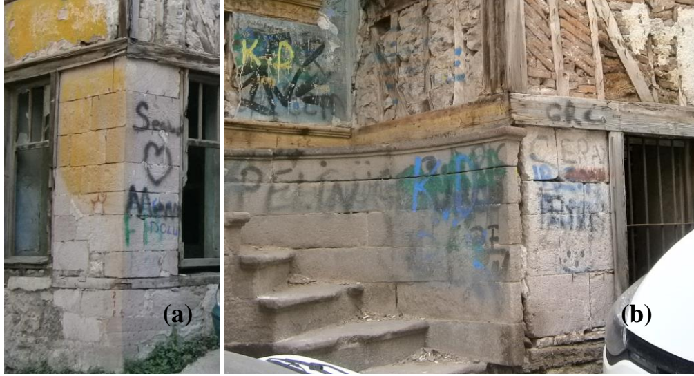
Şekil 6.7: Taş duvar örgüsünde derz boşalması [10]
