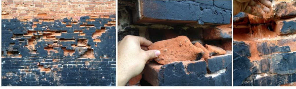
Şekil 3.26: Yangının tuğla üzerindeki yıkıcı etkisi [59]
