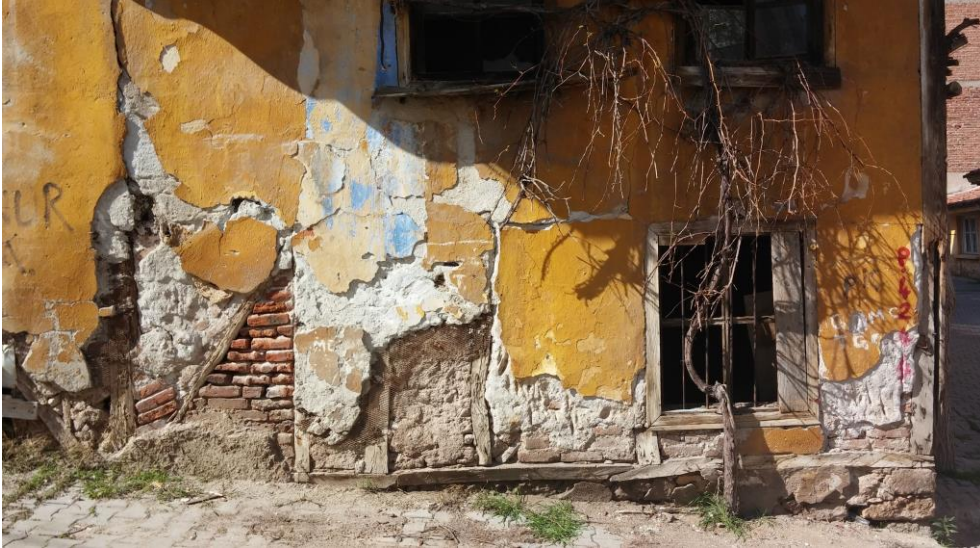
Şekil 6.30: Sıva harcında hatalı onarım sonucu bozulma[10]
