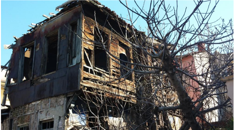
Şekil 6.23: Ahşap yapıda yangın etkisiyle malzemenin bozulması [10]
