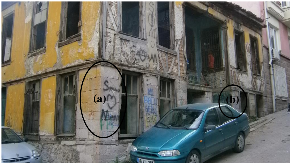
Şekil 6.7: Taş duvar örgüsünde derz boşalması [10]
