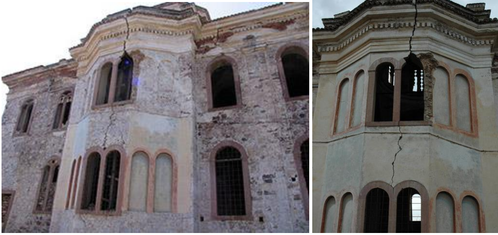
Şekil 3.2: Taşta meydana gelen yapısal çatlak [41]
