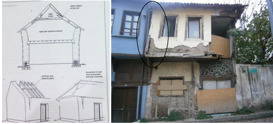
Şekil 3.42: Kerpiç yapıda çatı ve taşıyıcı yatay elemandan kaynaklı bozulma [27]
