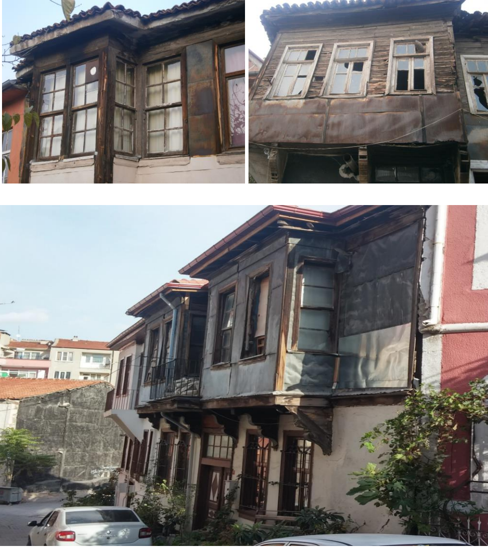
Şekil 6.20: Ahşapta metal korozyon etkisiyle bozulma [10]
