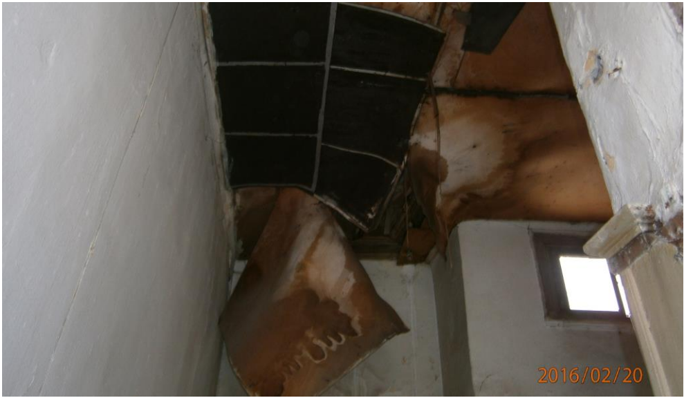
Şekil 6.21: Ahşap malzemede bakteri ve mantar etkisi [10]
