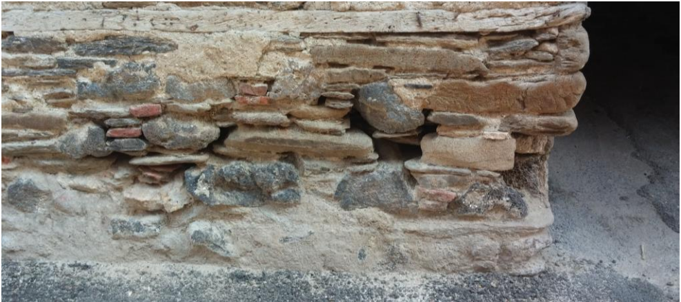
Şekil 3.6: Taş duvar örgüsünde derz boşalması [10]
