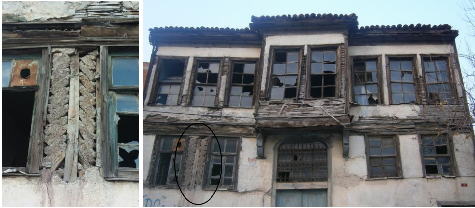
Şekil 6.24: Kerpiç dolgu malzemesinde bozulma [10]
