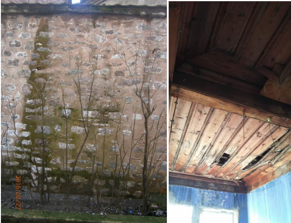
Şekil 2.11: Biyolojik nedenlerle farklı yapı malzemelerinde bozulmalar [10]
