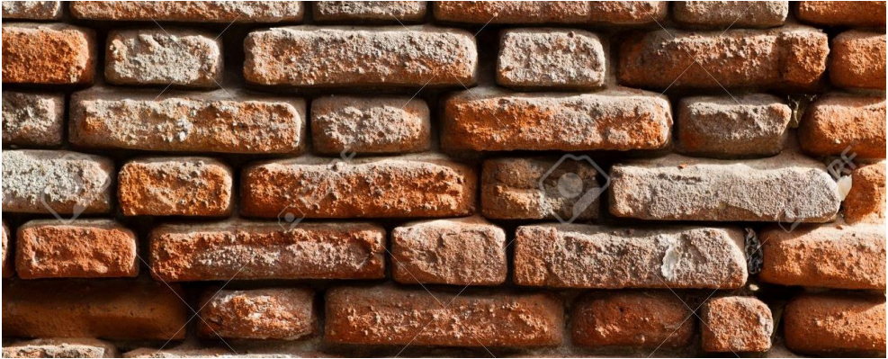
Şekil 3.20: Duvar örgüsünde derz boşalması [54]
