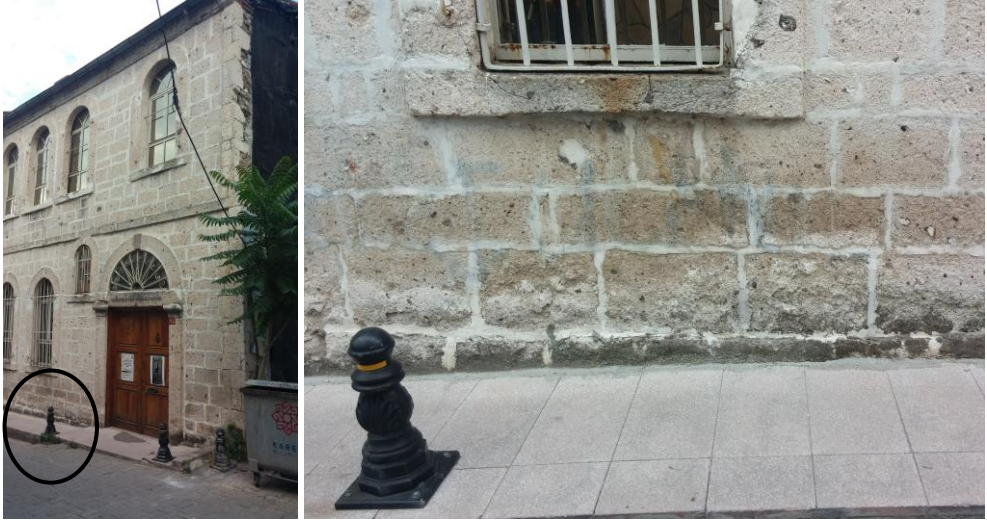
Şekil 6.9: Taş malzemede çiçeklenme (tuzlanma) [10]
