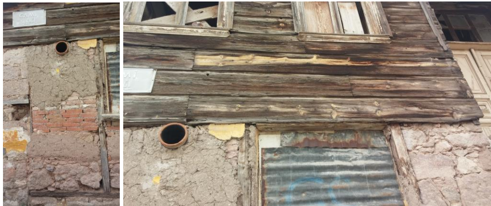
Şekil 6.28: Isı etkisiyle sıvada çatlak oluşumu [10]
