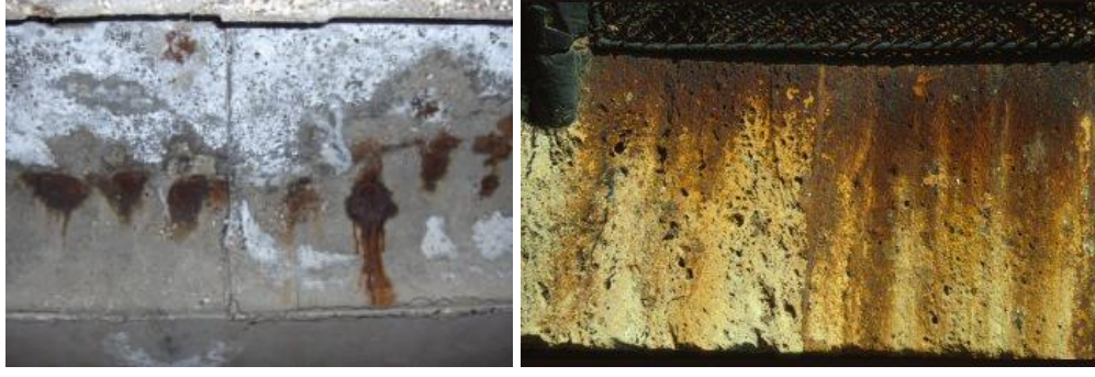
Şekil 3.15: Taş malzemeyle bağlantılı olan metallerde korozyon sonucu malzemede bozulma [51]
