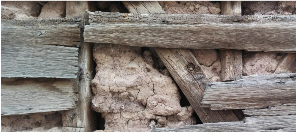
Şekil 6.25: Kerpiç dolgu malzemesinin ayrışması [10]
