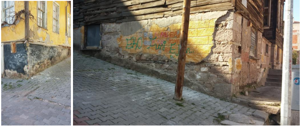
Şekil 6.27: Sıvalarda su ve nem etkisi [10]
