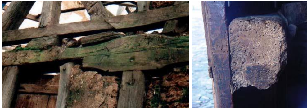
Şekil 3.35 : Ahşap yapı malzemesinde mantar-bakteri ve böcek kurt etkisi [10]
