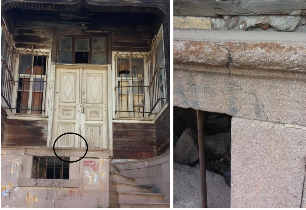
Şekil 6.11: Taş malzemede kılcal çatlak [10]
