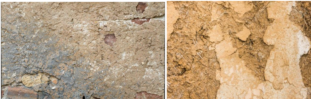
Şekil 3.46: Sıva harçlarında ufalanma [65]
