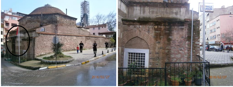
Şekil 6.4: Çatı sızıntı suları nedeniyle yüzey kirliliği [10]
