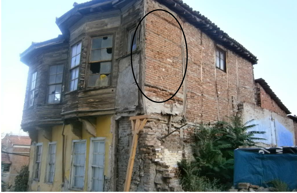
Şekil 6.12: Tuğla duvar örgüsünde yapısal sorun [10]
