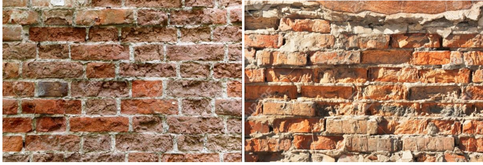
Şekil 3.24: Hatalı derz malzemesi kullanımdan kaynaklı tuğlada çözülme [58]
