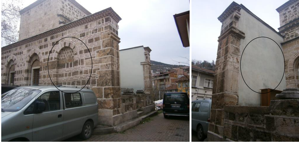
Şekil 3.13: Hatalı onarımın taş yapının bütünlüğüne etkisi [10]
