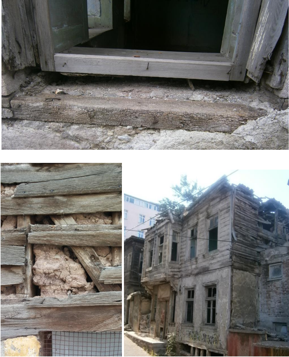
Şekil 6.18: Ahşap yapıda doku bozulması [10]
