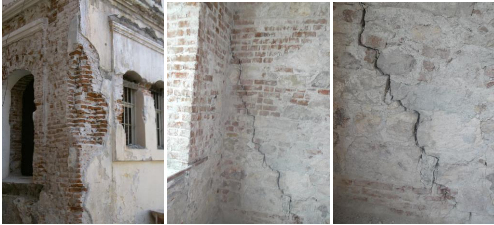
Şekil 3.27: Tuğla yapıda çatlaklar [7]
