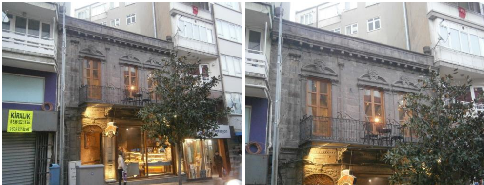
Şekil 2.10: Atmosfer etkileriyle taş yapı yüzeyinde siyah lekelenmeler [10]
