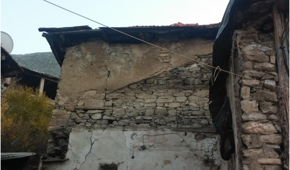
Şekil 3.43: Harçlarda rötne çatlağı [10]
