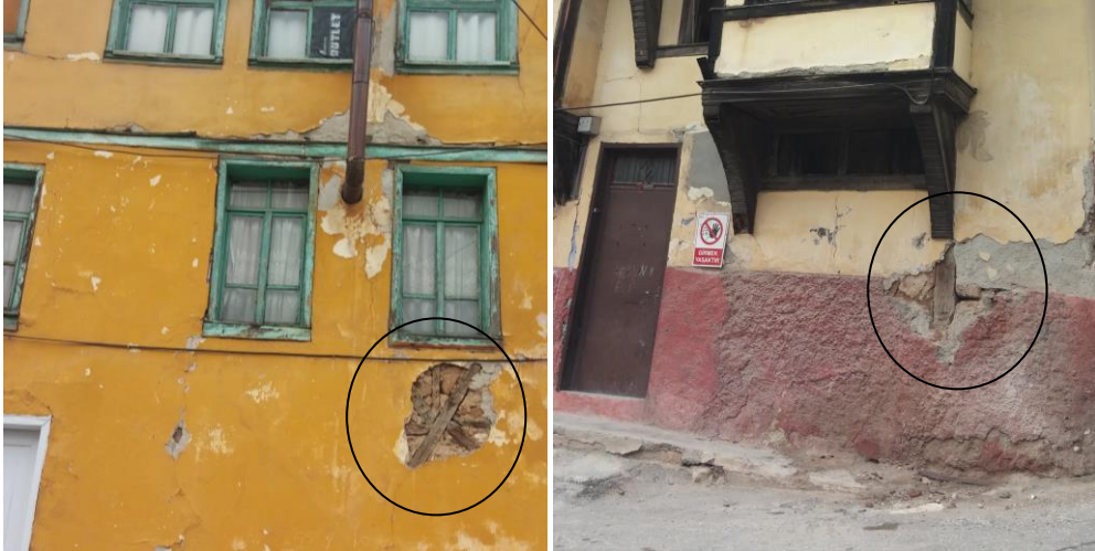
Şekil 3.45: Sıva harcında dökülmeler sonucu malzeme kaybı [10]
