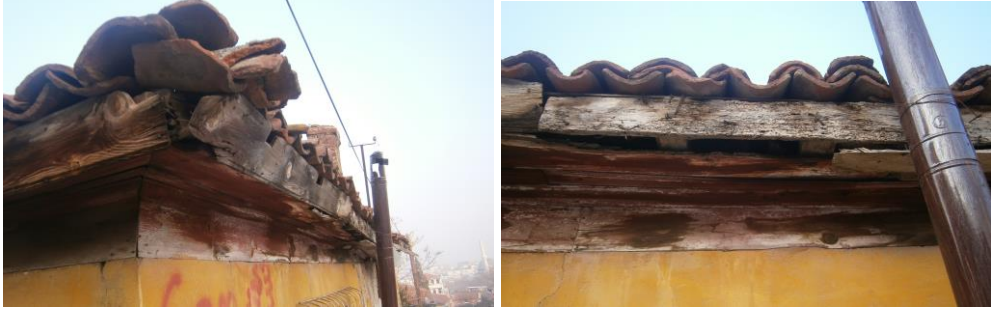
Şekil 3.33: Ahşap çatı malzemesinde kirlilik sonucu renk deđişimi [10]
