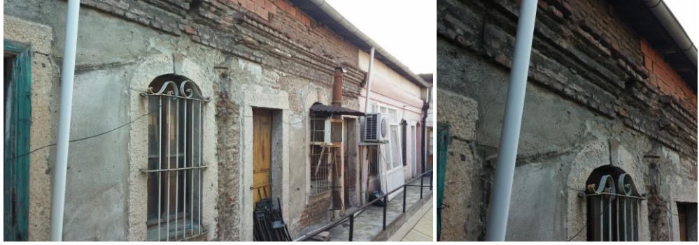
Şekil 6.14: Tuğla yüzeyinde kirlilik [10]
