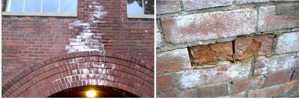
Şekil 3.21: Tuğlada tuz etkisiyle tuzlanma (çiçeklenme) [56]
