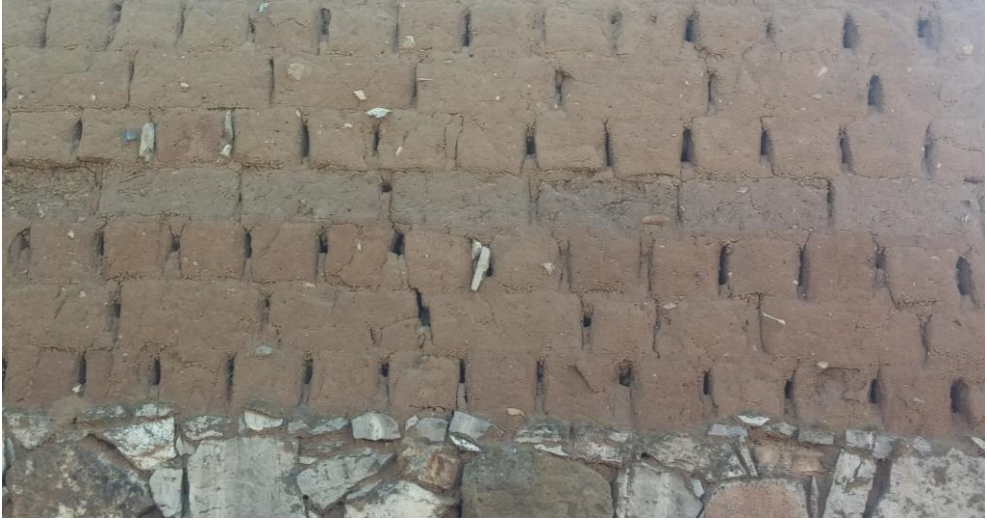
Şekil 3.39: Kerpiç yapı bloklarında kuruma (rötre) çatlağı [10]
