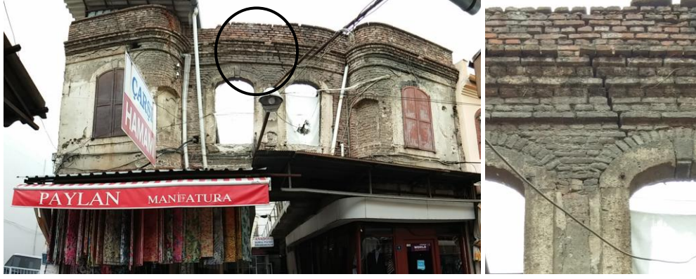
Şekil 6.15: Ani yük değişimiyle oluşan yapısal çatlak [10]
