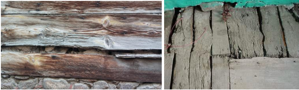
Şekil 3.30: Ahşap malzemede aşınma [10]
