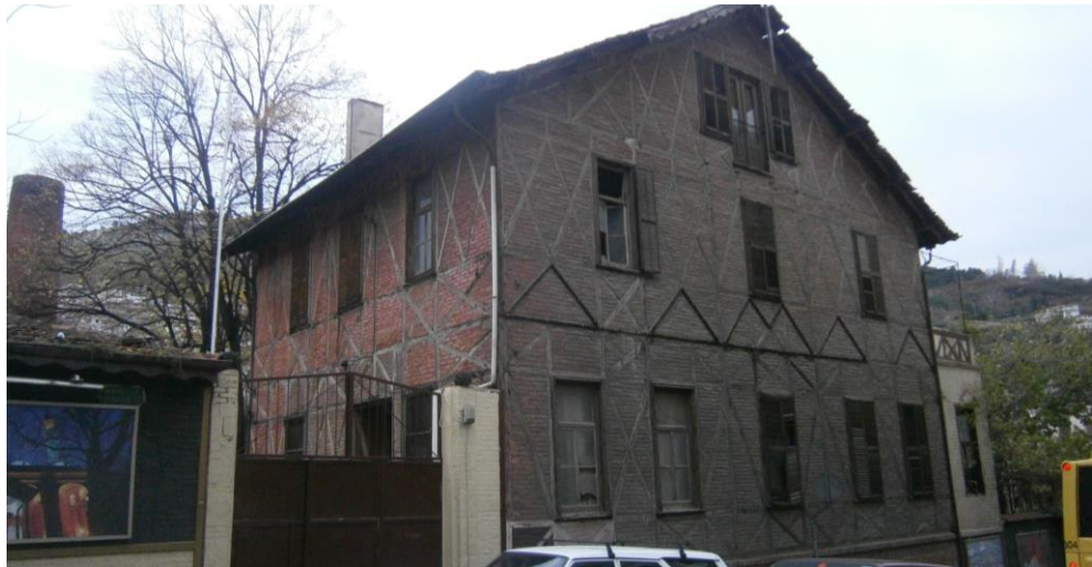
Şekil 3.22: Tuğla yüzeyinde çeşitli sebeplerle oluşmuş kirlilik [10]
