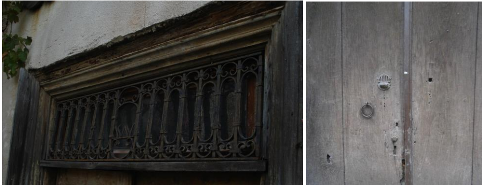
Şekil 3.48: Kapı üstündeki ferforjenin korozyonu sonucu ahşaba etkisi [7]
