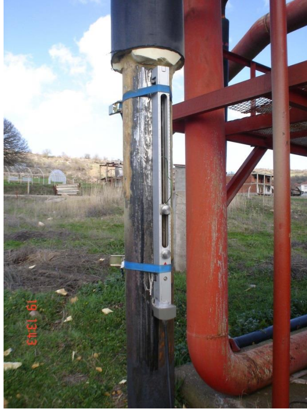
Şekil 4.17: Gaz separatörü kuyu bağlantı noktasında kuyu debisi ölçüm çalışması.
