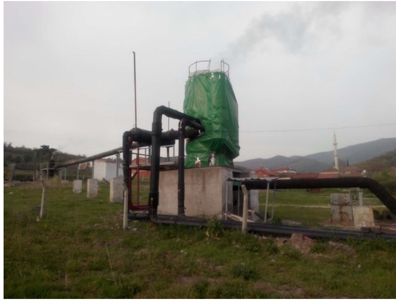
Şekil 4.7: Hisarköy'de bulunan gaz seperatörü ve kuyu bağlantı boruları.
