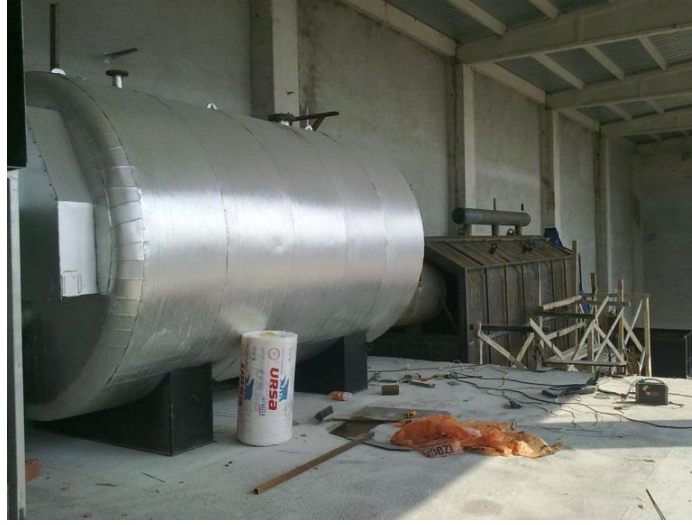
Şekil 4.13: Bigadiç JBIS kömür kazanı ünitesi, ön ocak (sağda) ve kazan (solda) bölümleri.
