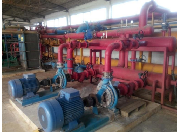
Şekil 4.9: Isı merkezinin içeriden görünümü.
