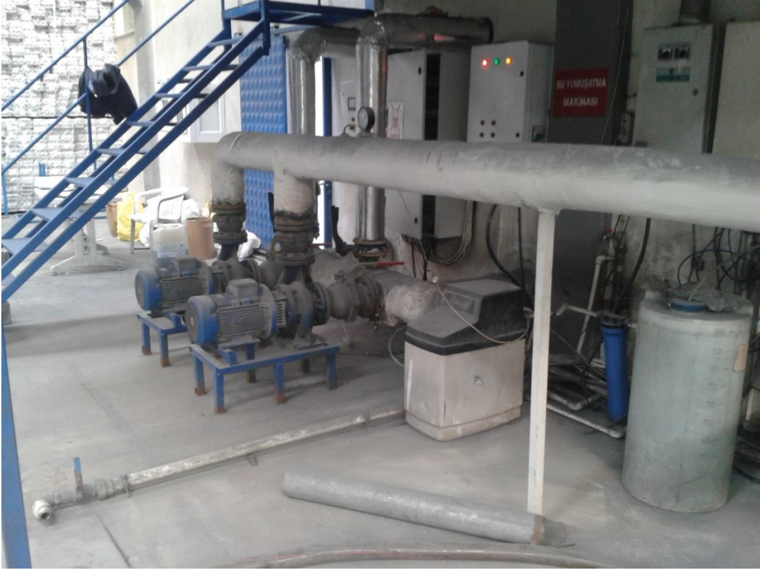
Şekil 3.5: Kalıplara Su Basan Pompalar (3 . 15kW)
