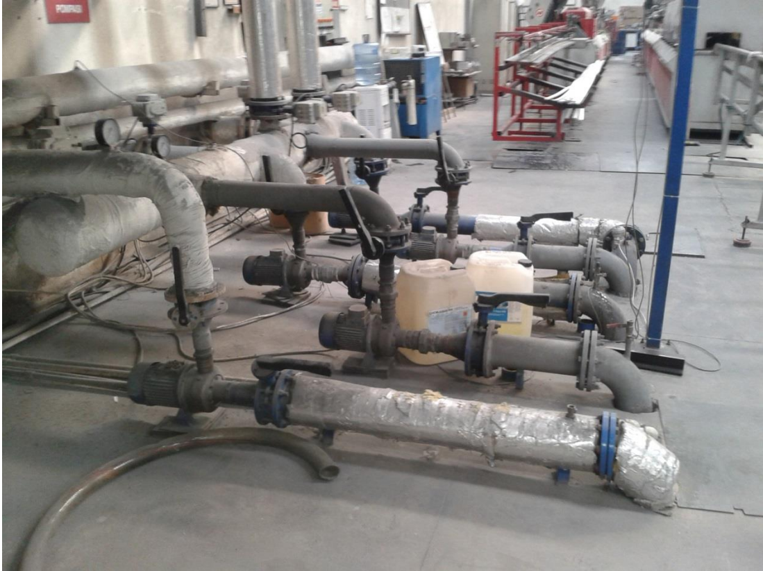
Şekil 3.4: Soğutma Gruplarına Su Basan Pompalar (5 . 2.2kW)
