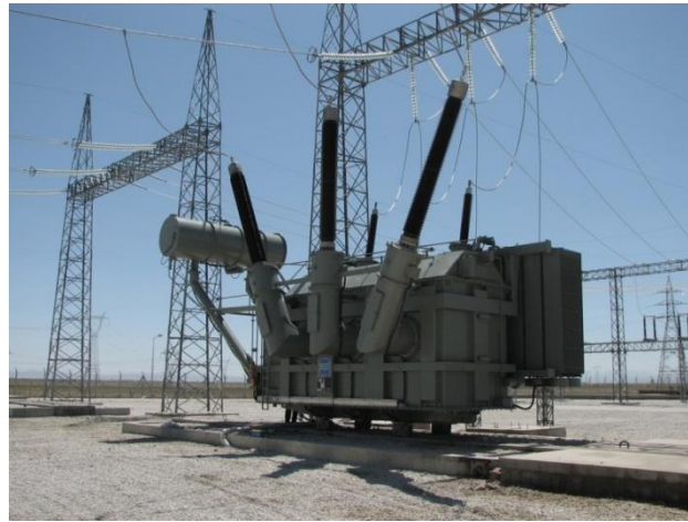
Şekil 1.8: Genleşme depolu transformatör.
