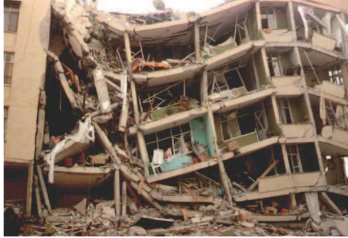
Şekil 1.2: Adana-Ceyhan depreminde yıkılmış dişli döşeme sistemli bina [8]
