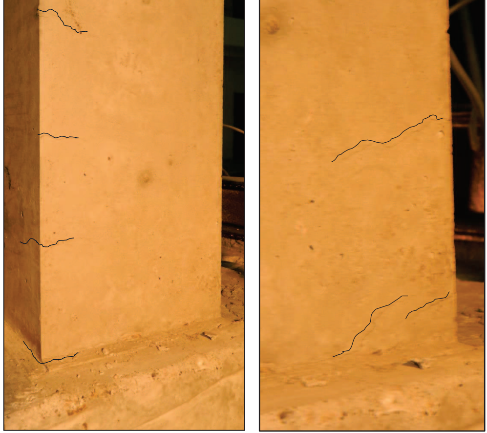
Şekil 2.15: GK-1-T numunesi a) İtmede ilk çatlakların oluşumu b) Çekmede ilk çatlakların oluşumu
