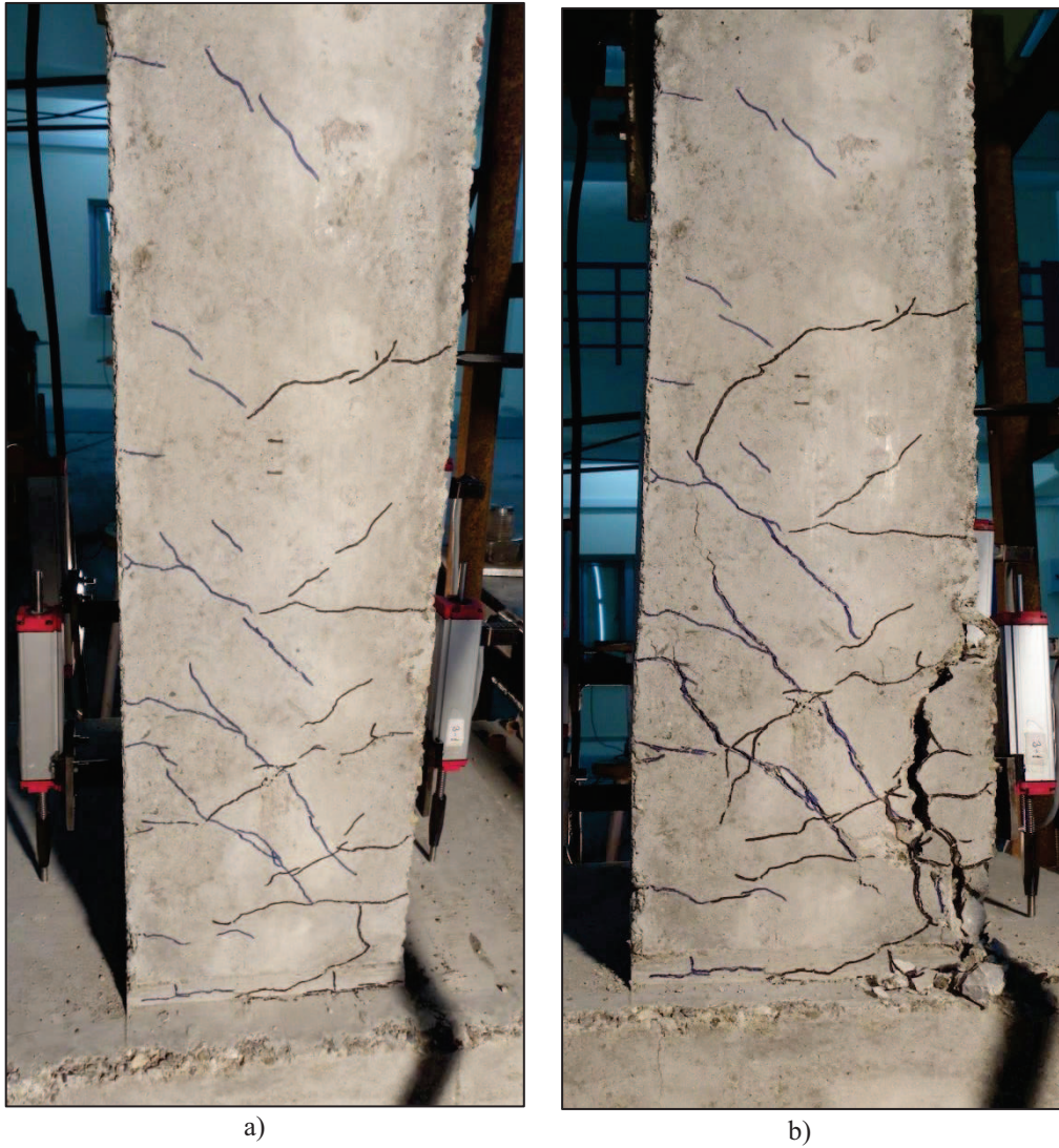
Şekil 2.32: a)%2.0 itme ötelenme oranında b)%2.83 itme ötelenme oranında hasar durumu
