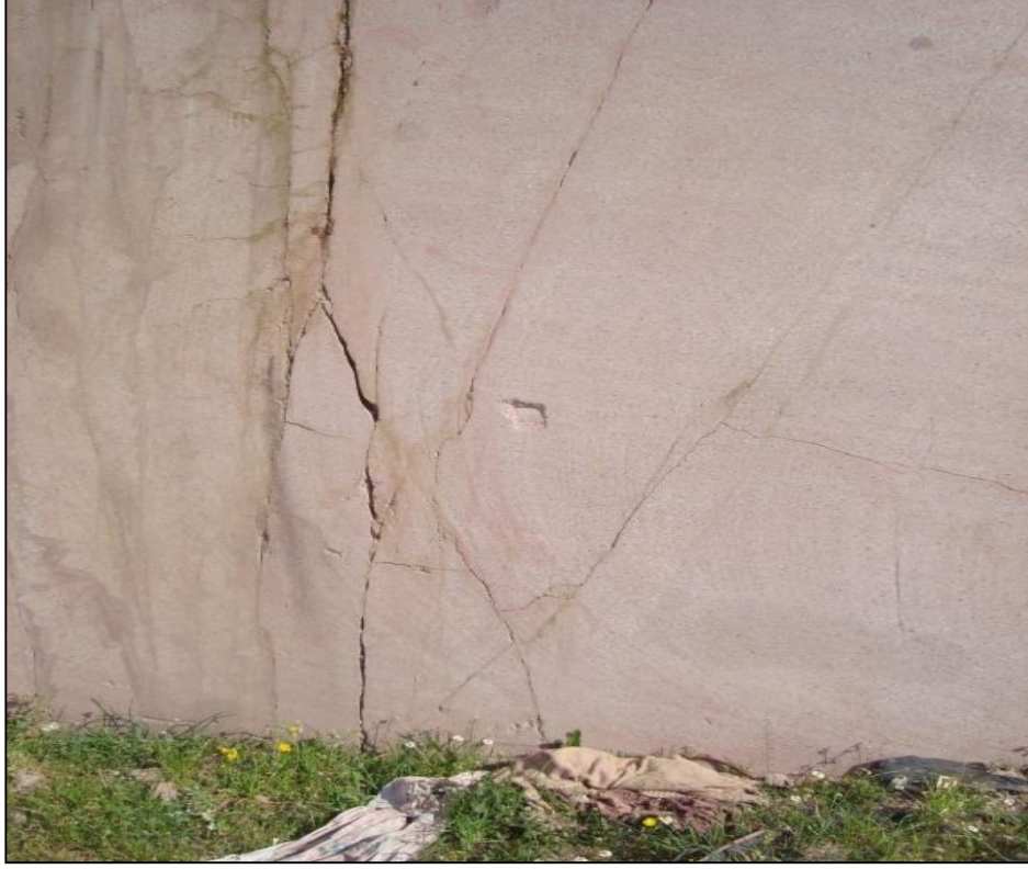
Şekil 3.22 : Taş Ocağı olarak işletilen Şapçı andezitinde çatlak görünüşleri.
