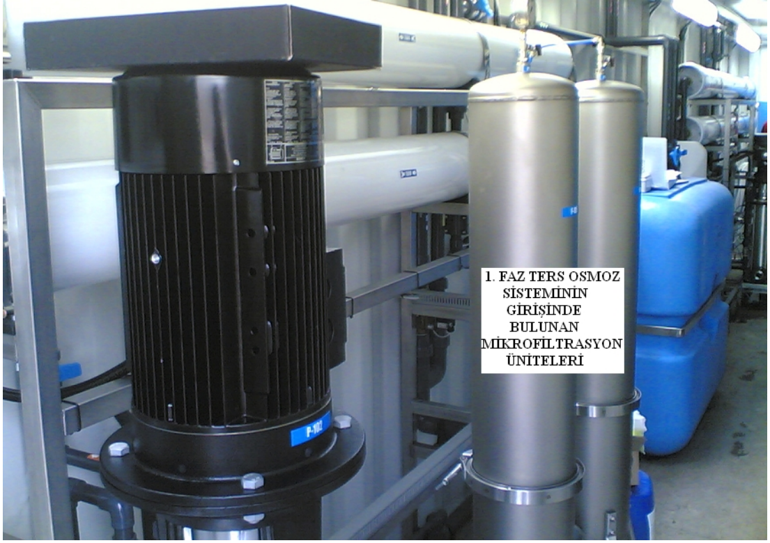
Şekil 3.6 Birinci faz ters osmoz sisteminin girişindeki mikrofiltrasyon ünitelerine ait ekipmanlar
