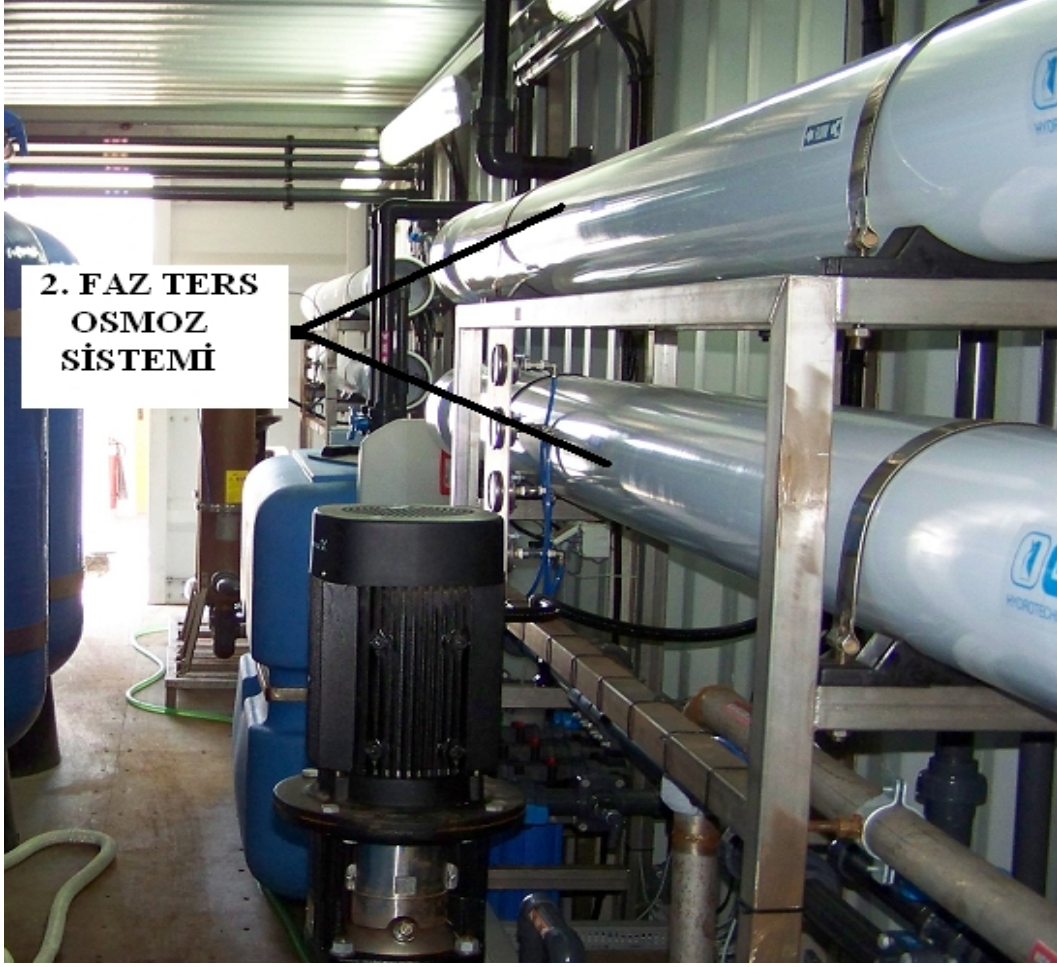
Şekil 3.10 İkinci faz ters osmoz sistemi
