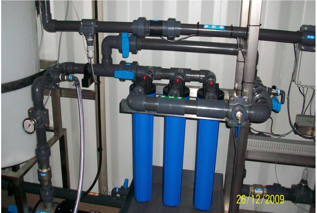
Şekil 3.9 İkinci faz ters osmoz sisteminin girişindeki mikrofiltrasyon ünitesine ait ekipmanlar
