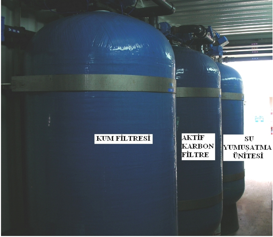
Şekil 3.5 Ham su şartlandırma işlemini gerçekleştiren filtrasyon üniteleri
