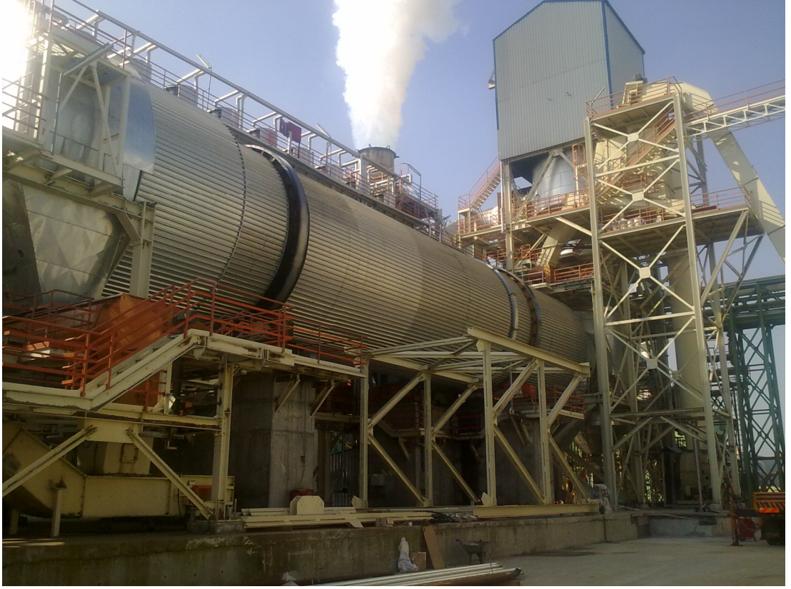
Şekil 5.7 Brulör ve Kurutucu Genel Görünüm
