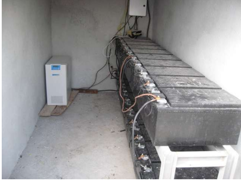
Şekil 4.5 Evirici, aküler ve kontrol sistemlerinin yerleşimi.
