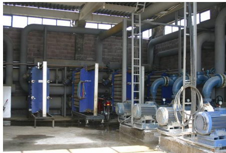
Şekil 5.2 Simav Jeotermal Bölgesel Isıtma Sisteminin Eşanjör Dairesine Ait Resimleri.
