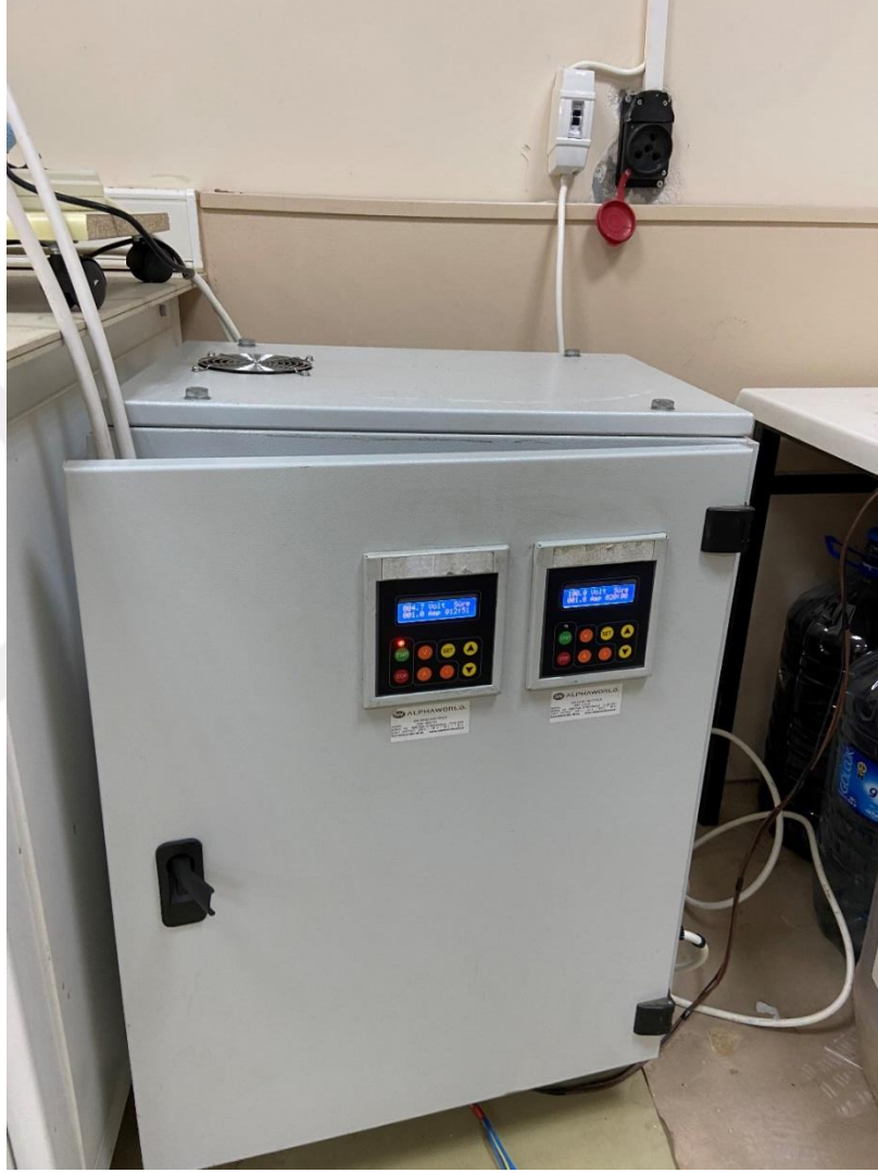
Şekil 3.4: Deneilerde kullanılan güç kaynağı
