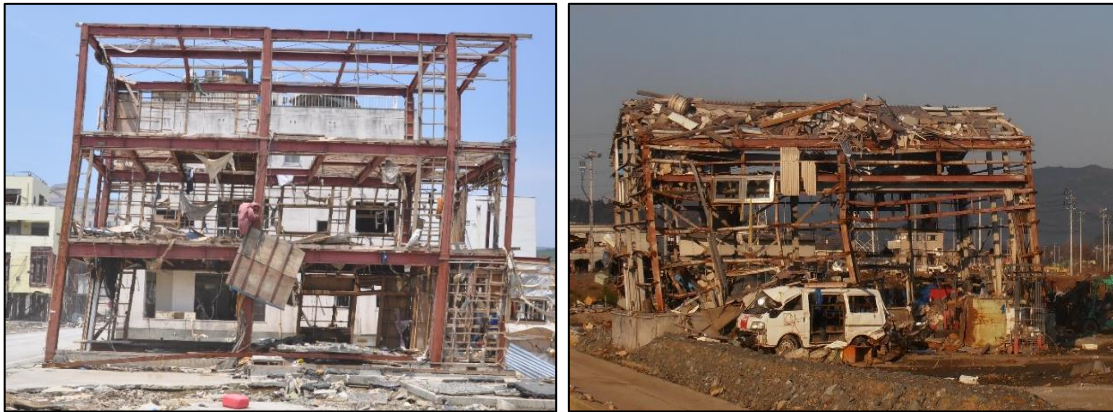
Şekil 1.3: 2011 Tohoku depremi ve tsunami nedeniyle kalıcı ötelemelere maruz kalan çelik binalar.
