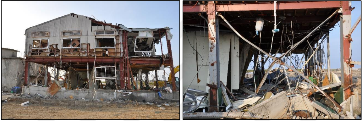
Şekil 1.2: 2011 Tohoku depremi sonrası kalıcı yanal ötelemeye maruz kalmış çelik yapı.
