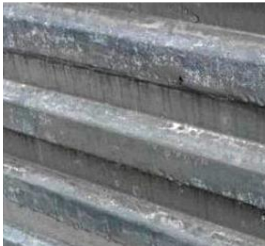
Şekil 6.12: Galvanizli saclarda atmosferik koşullara bağlı beyaz pas oluşumu [35].
