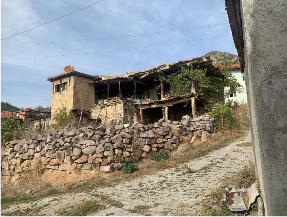
Şekil 4.74: Taşıyıcı sistem düzeyinde bozulma örneği (Kişisel Arşiv, 2023).
