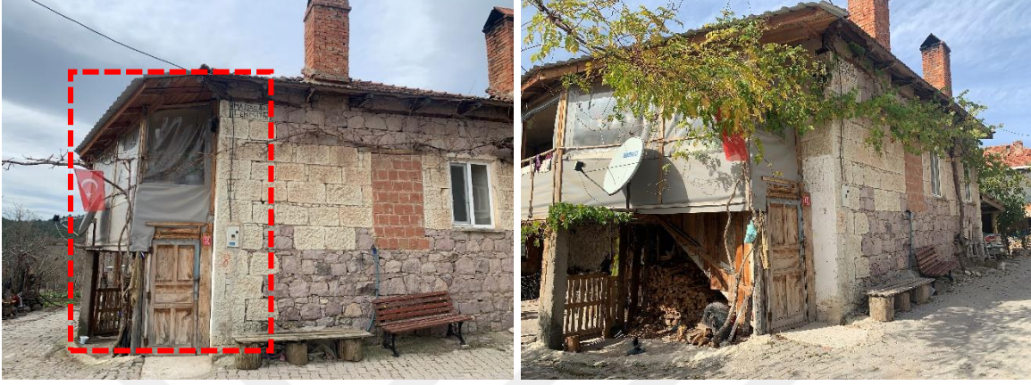
Şekil 4.26: 115 ada 22 parselde kayıtlı Eyüp Çelik evi, açık giriş mekânının sonradan ek hacim eklenip kapatılması örneği (Kişisel Arşiv, 2023).
