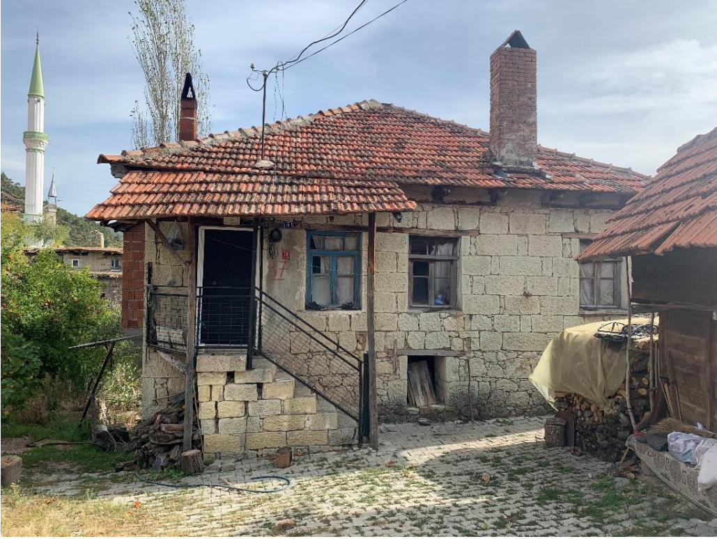
Şekil 4.72: Yapı eleman düzeyinde bozulma örneği (Kişisel Arşiv, 2023).
