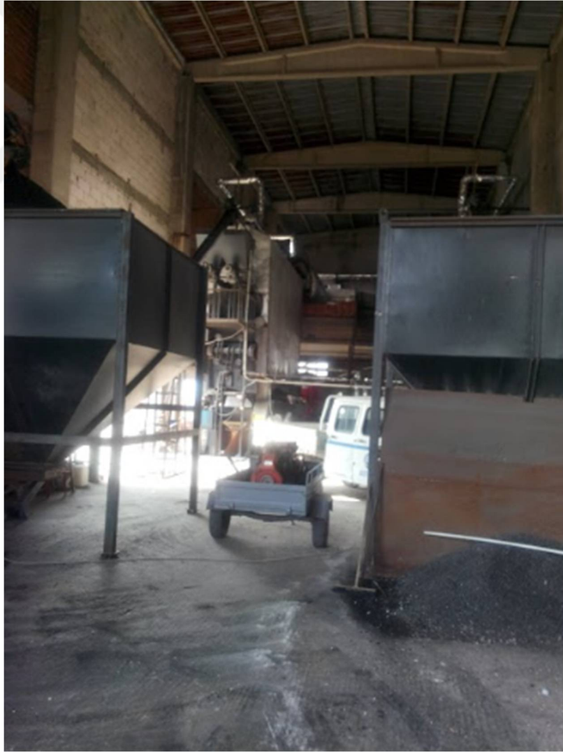
Şekil 3.10: Bigadiç JBIS kömür kazan ünitesi.
