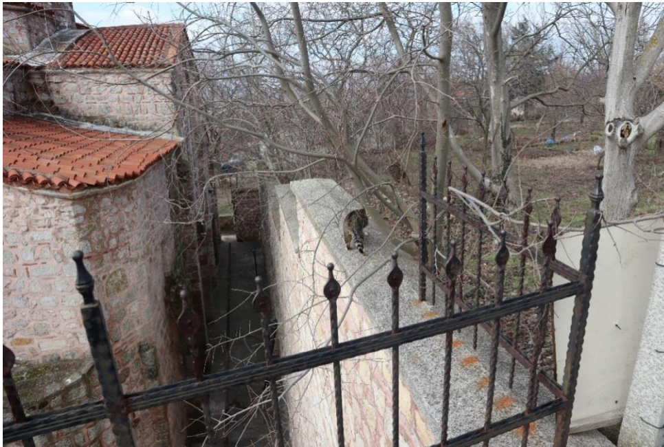
Şekil 6.13: Gazi Süleyman Paşa Camii'nin doğu cephesindeki yol ile arasındaki kot farkı (Kişisel arşiv).
