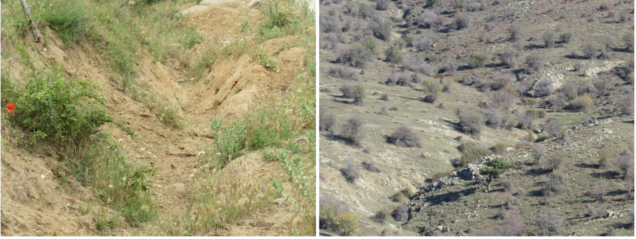
Şekil 17. Granodiyorit anakayası üzerinde gelişen oyuntu erozyonu (Yukarıcuma- Çamavlu arası). 10 numaralı istasyon üzerinde yıllık hektar başına 43 tondan fazla toprak erozyonu kayıpları meydana gelmektedir
