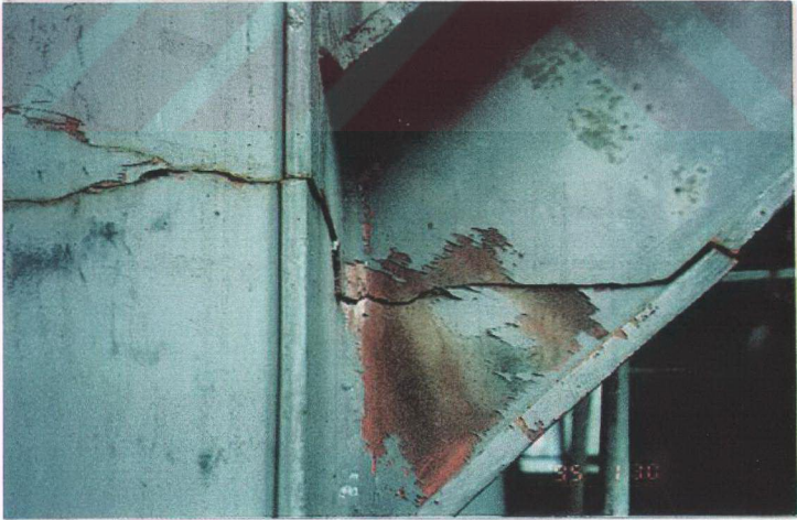
Şekil 4.2 Yatay Yük Etkisiyle Çelik Profil Kesitte Meydana Gelen Hasar
