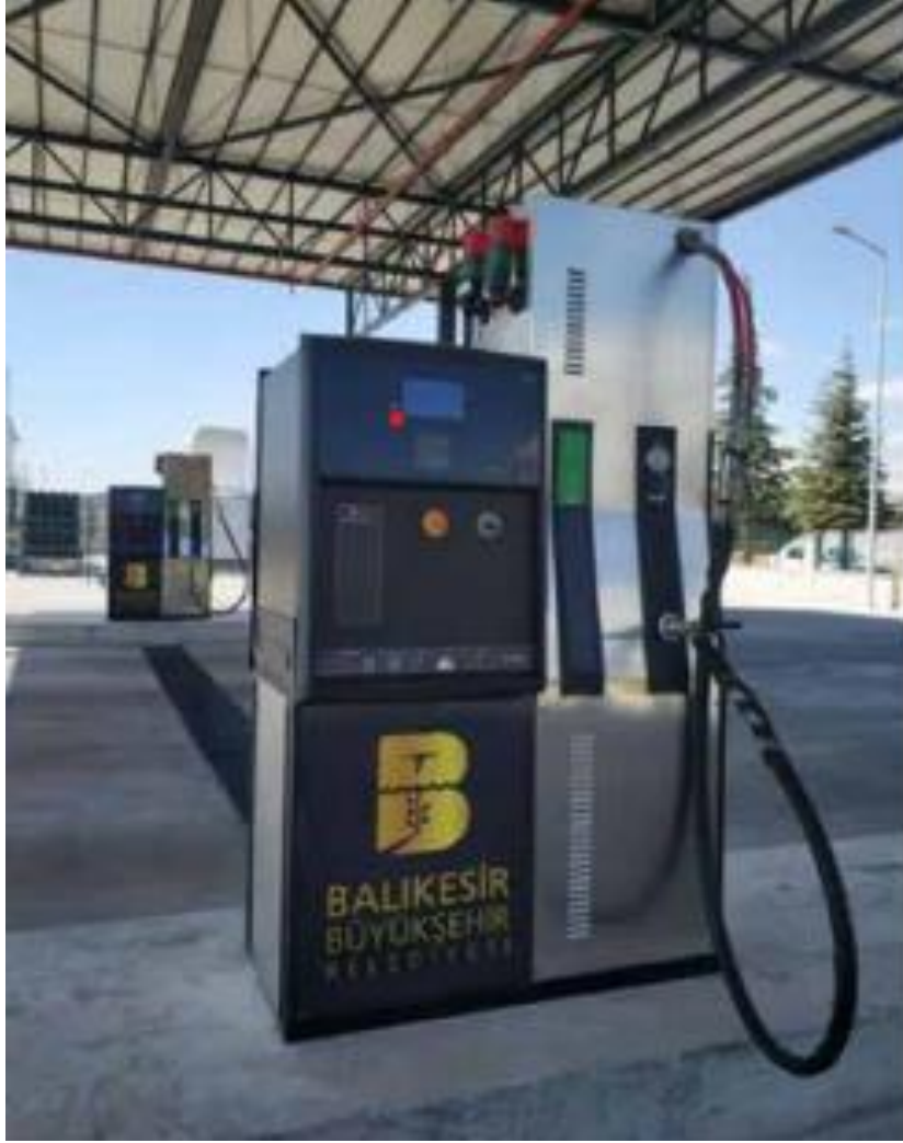
Şekil 9. CNG (Sıkıştırılmış Doğalgaz) Yakıt Dolum İstasyonu
