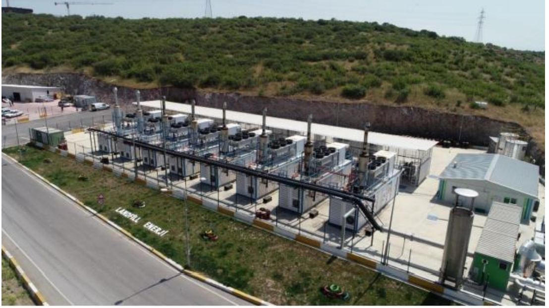
Şekil 17. LFG Enerji Üretim Santrali
