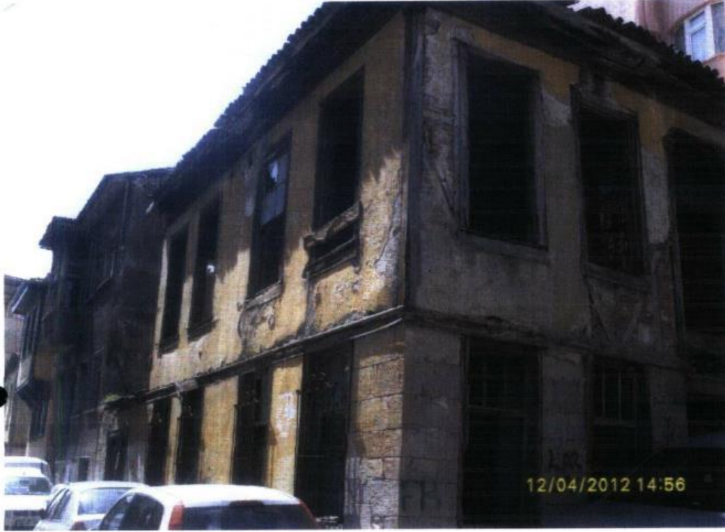
Şekil 6.35: 3 numaralı yapı mail-i inhidam raporu fotoğrafı (Balıkesir Kültür Varlıklarını Koruma Bölge Kurulu Müdürlüğü arşivi).
