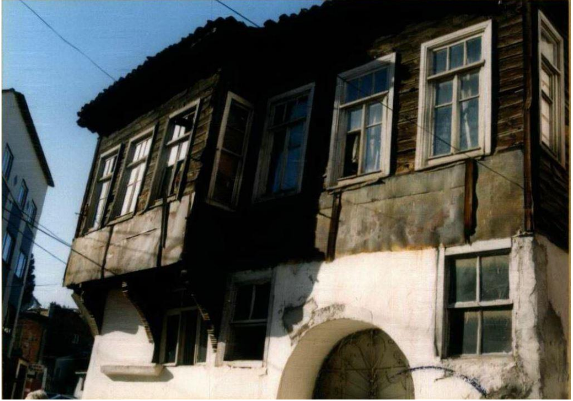
Şekil 6.395: 25 numaralı yapı arşiv fotoğrafı (Balıkesir Kültür Varlıklarını Koruma Bölge Kurulu Müdürlüğü arşivi).
