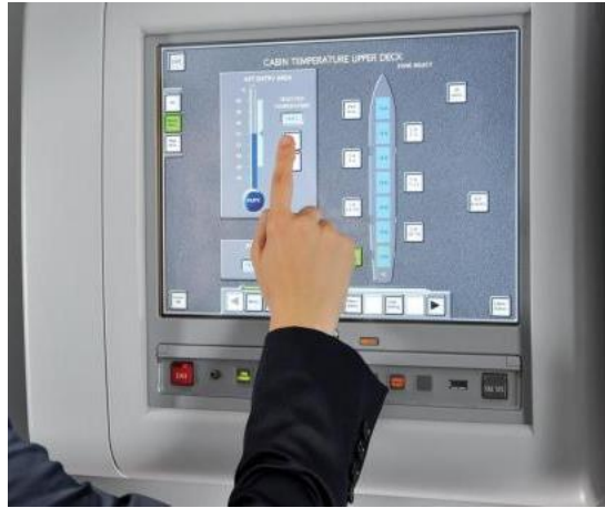
Şekil 5.1: Kabin içi kontrol ünitesi.
