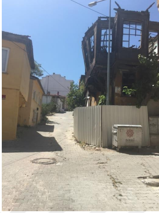
Şekil 68. Aygören Mahallesi'nde Tehlike Oluşturan Eski Konuttan Bir Görünüm
