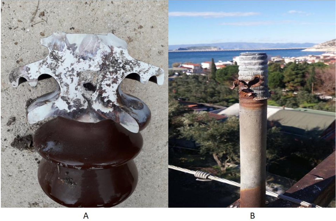
řekil 3.11: Gündoędu enerji nakil hattında kısmi deřarja neden olan izolâtör.
