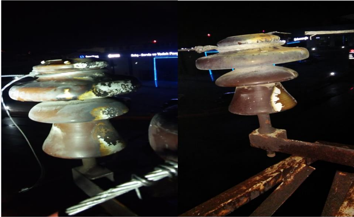
Şekil 3.8: Saraylar enerji nakil hattında kuru band yüzünden kısmi deşarja neden olan izolatör.
