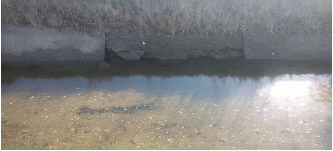
Fotoğraf 8: Sulama Kanallarındaki Çatlaklar, Balıkesir/Atköy Kırsal Mahallesi.
