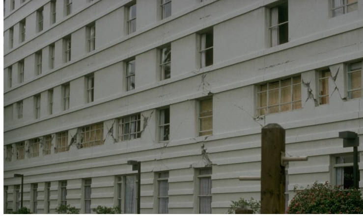
Şekil 1.2: Northridge (1994) depreminde ağır hasar görmüş bina
