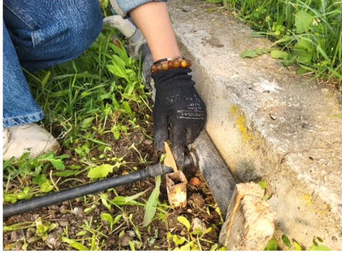
13.Su kaynağının vanasını kapatır
