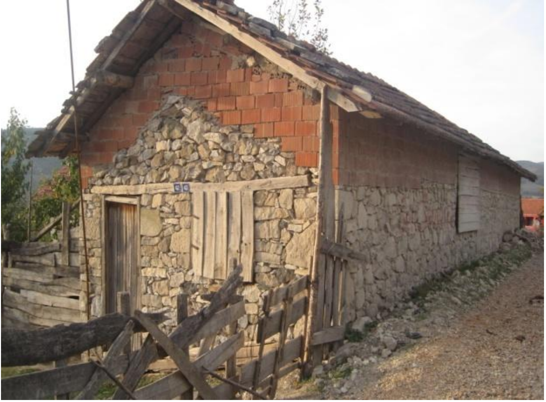
Şekil 46. Modern Malzeme ile Ekleme Yapılmış Ahır-Şabanlar Köyü
