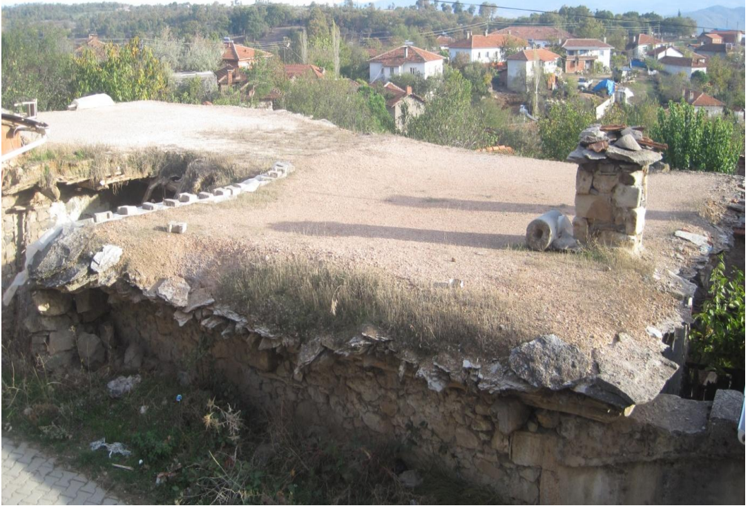
Şekil 25. Bir Kısım Çökmüş Toprak Dam-Akbaşlar Köyü
