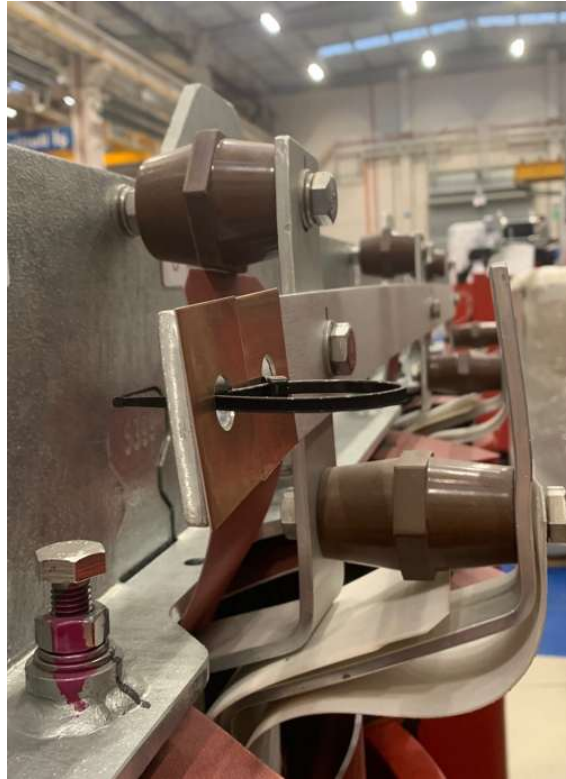
Şekil 1.2: Trafo üzerine montajlı izolatör
