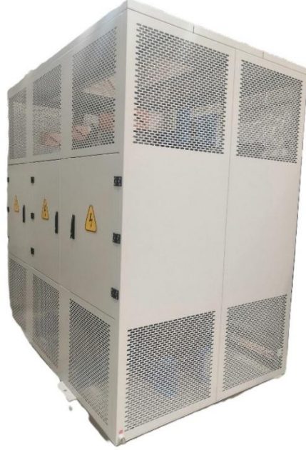
Őekil 1.8: IP21 muhafaza kabinli KTT.
