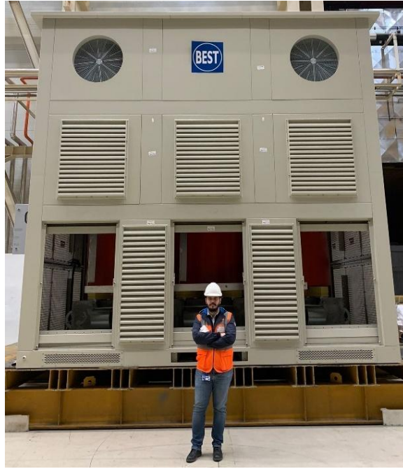
Şekil 1.11: IP54 muhafaza kabinli KTT.
