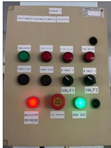
Şekil 4.33: Hidrolik sistem uzak kontrol elektronik panosu
